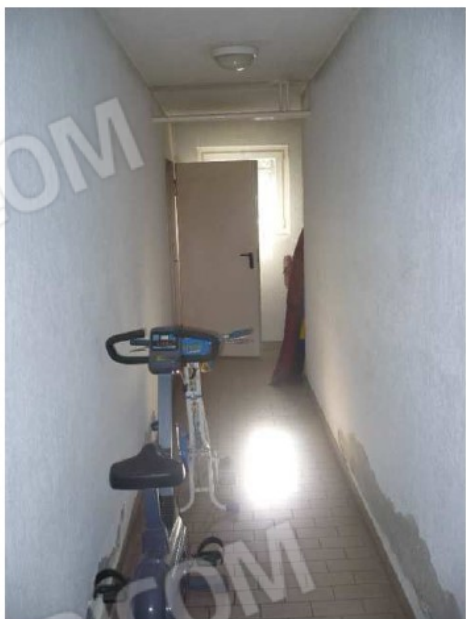
25 – Vista disimpegno locale caldaia
