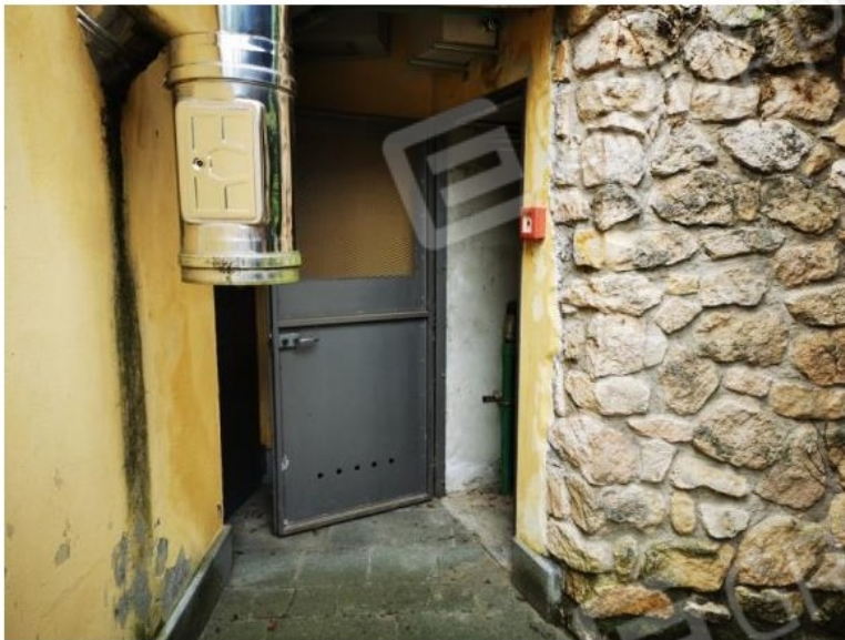
Piscina scoperta – Centrale termica
