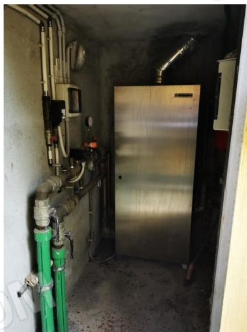
Piscina scoperta - Centrale termica
