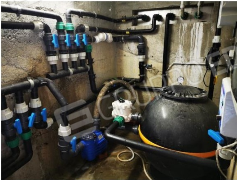
Piscina scoperta - Vano tecnico ed impiantistica
