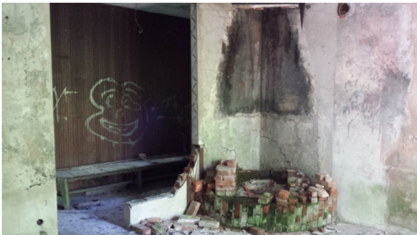
dettaglio 06 fabbricato civile diroccato in via Bagno
