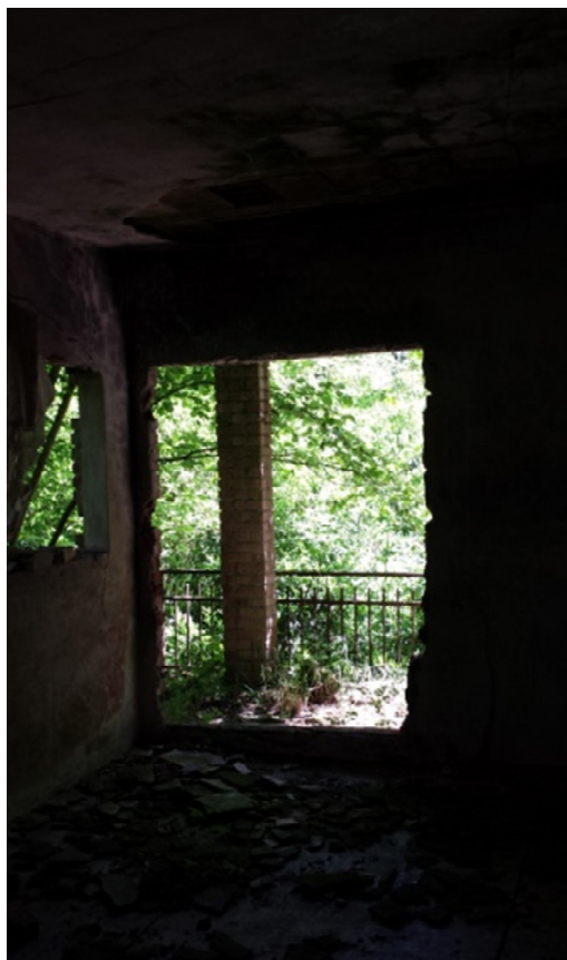
dettaglio 07 fabbricato civile diroccato in via Bagno
