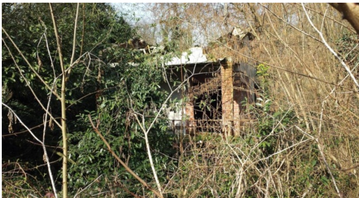
dettaglio 04 fabbricato civile diroccato in via Bagno
