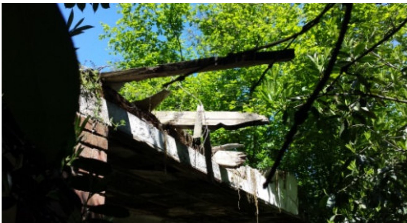
dettaglio 09 fabbricato civile diroccato in via Bagno
