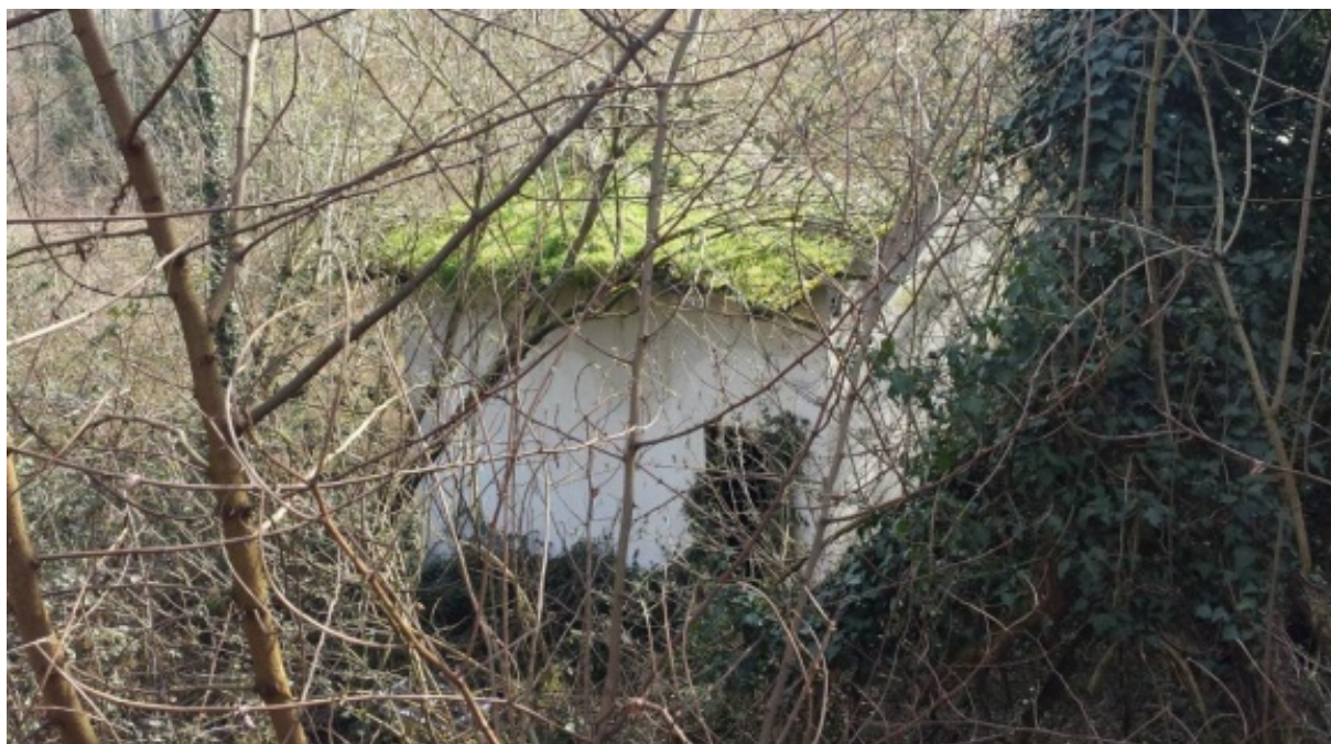
dettaglio 03 fabbricato civile diroccato in via Bagno
