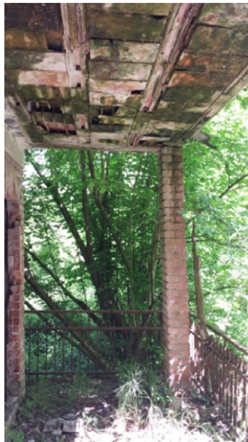
dettaglio 08 fabbricato civile diroccato in via Bagno
