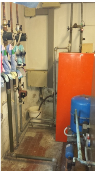
Centrale termica dell'edificio di guardiania
