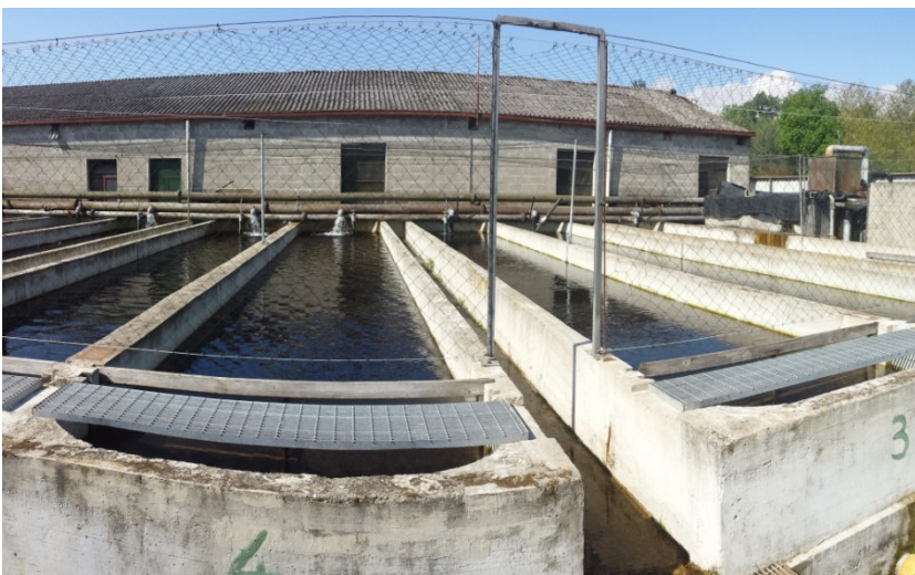
vaschette di 2° fase e tettoia accessoria all'allevamento
