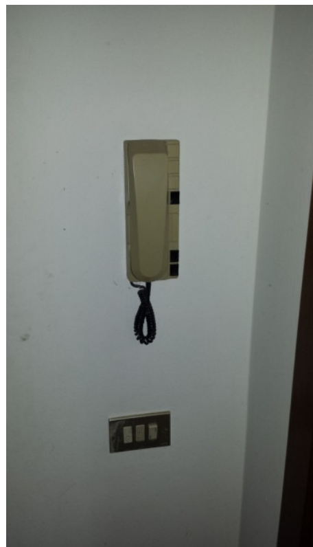
Alloggio del custode: dettaglio citofono e comandi impianto elettrico
