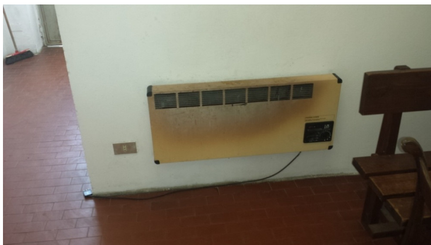
Dettaglio del sistema di riscaldamento elettrico all'interno dei locali accessori per il personale
