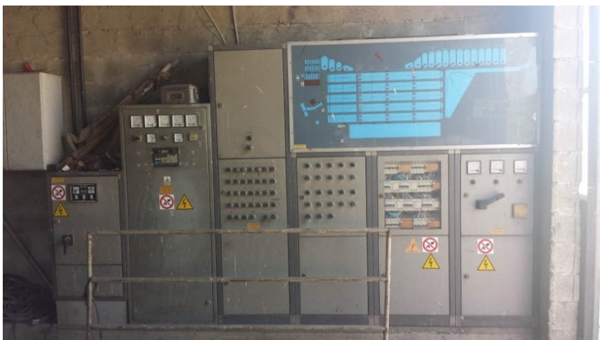
Locale tecnico con quadro elettrico e di gestione dell'impianto
