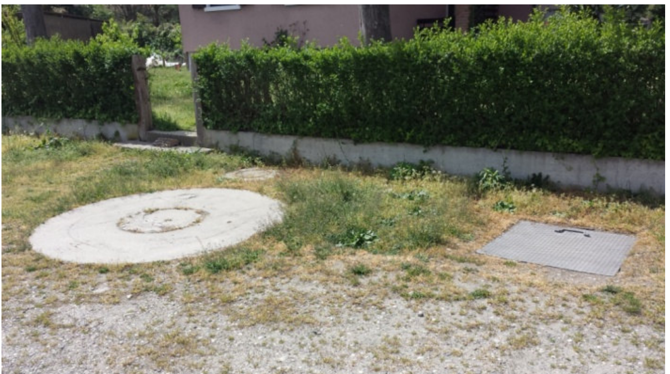
Vasca imhof per lo scarico delle acque reflue (alloggio custode e locali personale)
