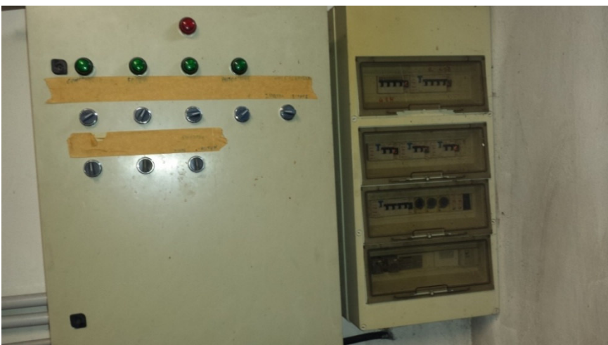
Quadro elettrico all'interno della centrale termica
