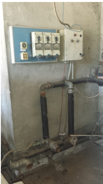
Dettaglio di quadri elettrici a servizio dell'attività
