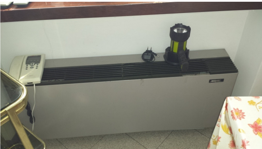
Particolare dei diffusori di riscaldamento dell'alloggio del custode
