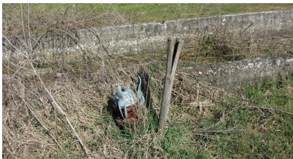
dettaglio 20 bocchettone dell'impianto di sollevamento per acqua irriqua
