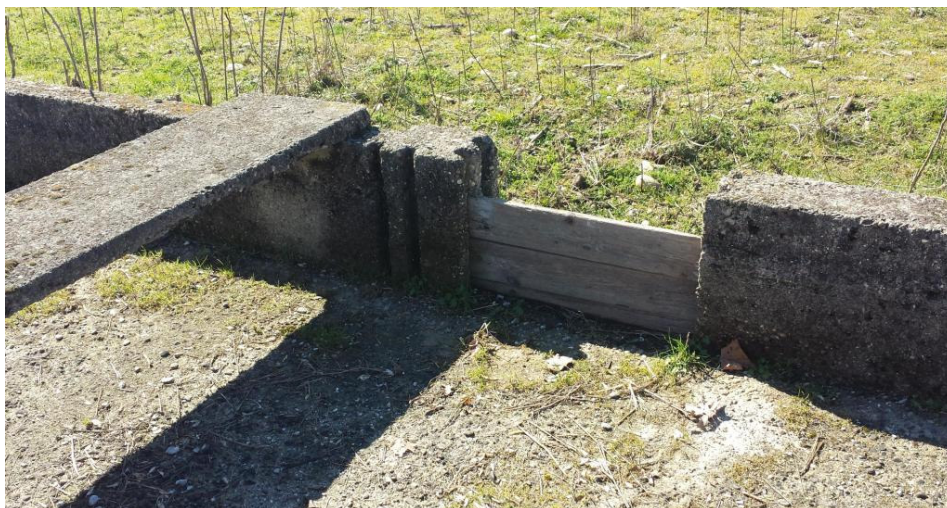
Dettaglio di una bocchetta di irrigazione sulcanale irriguo a lato dei terreni di cui al lotto 4b
