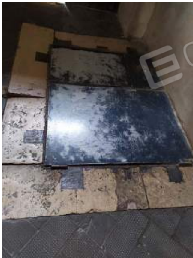
Foto 8 – botola d'accesso al locale interrato inaccessibile (da androne vano scala)
