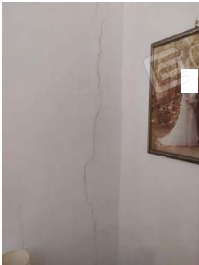
Foto 10 – lesioni da schiacciamento nelle pareti portanti (zona notte)
