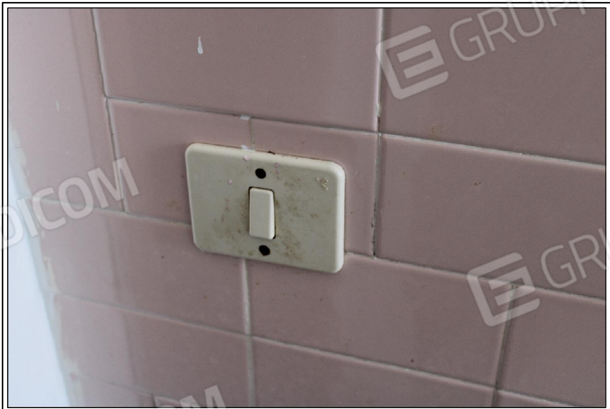
FOTO N° 48 - PARTICOLARE IMPIANTO ELETTRICO
