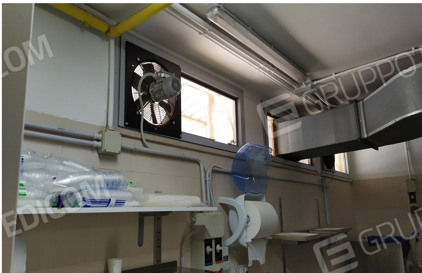
FOTO I.28: in evidenza, la cucina con i suoi impianti ed attrezzature varie.
