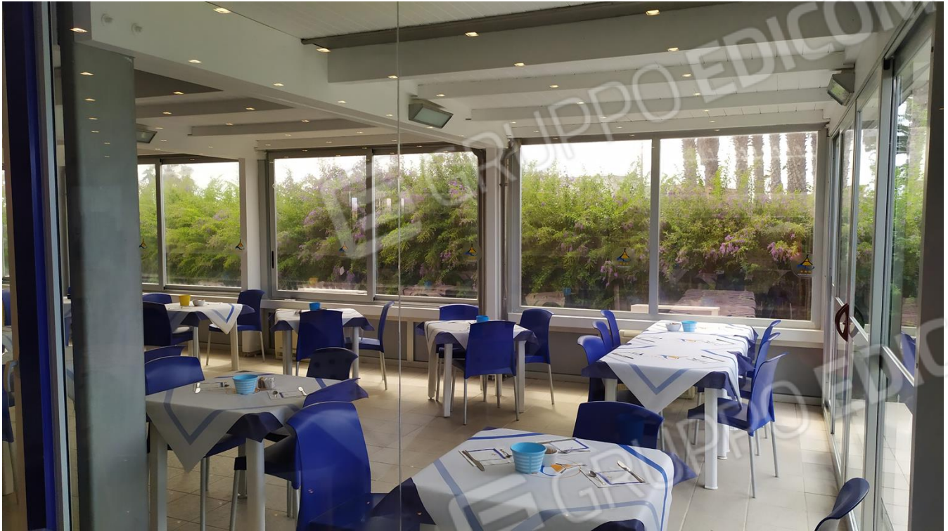
FOTO I.25: in evidenza, l'ampliamento della sala ristoro realizzato senza titolo edilizio, insanabile, da rimuovere/demolire.
