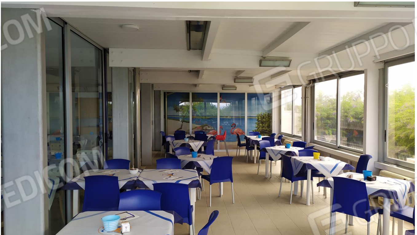
FOTO I.26: in evidenza, l'ampliamento della sala ristoro realizzato senza titolo edilizio, insanabile, da rimuovere/demolire.
