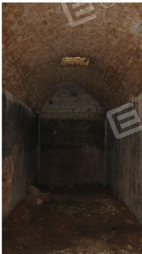
Foto n.49: vista dell'ambiente adibito a grotta del centro benessere all'interno dell'immobile D, secondo quanto previsto da progetto.
