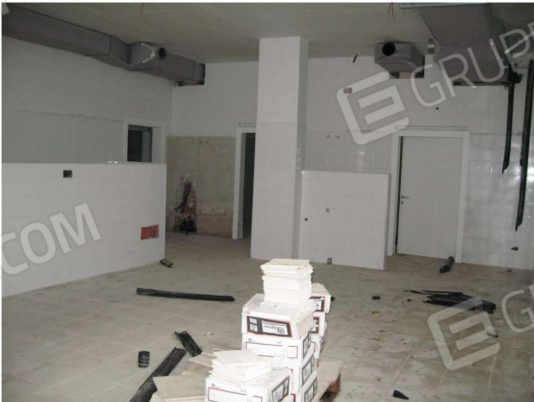
Foto n.32: cucina del ristorante. Immobile C.
