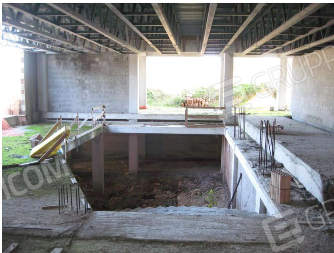
Foto n.45: vista del livello interno più alto dell'Immobile D, centro benessere, area a doppia altezza.
