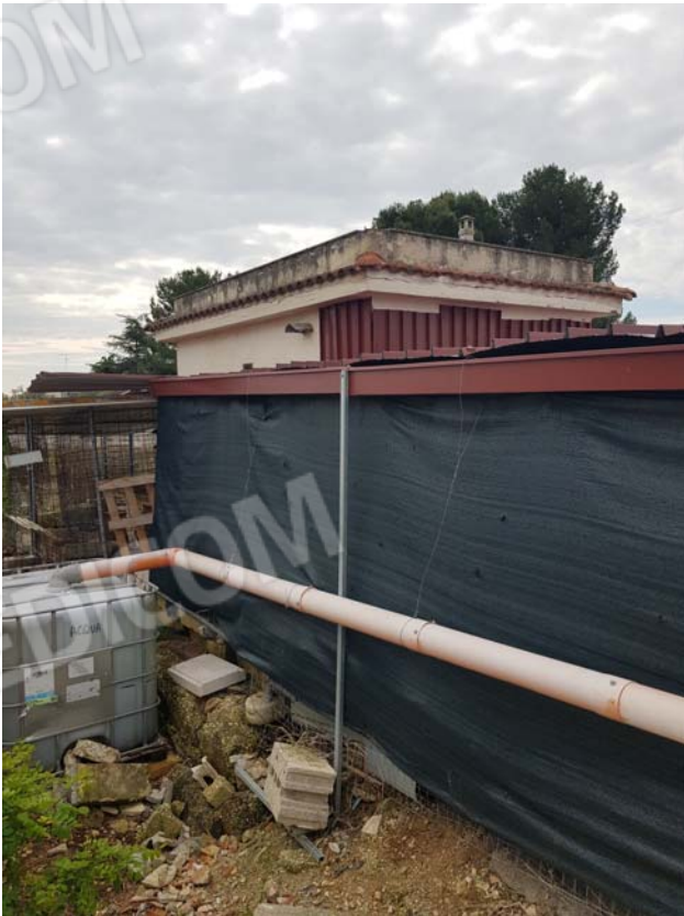
macerie della villa crollata
