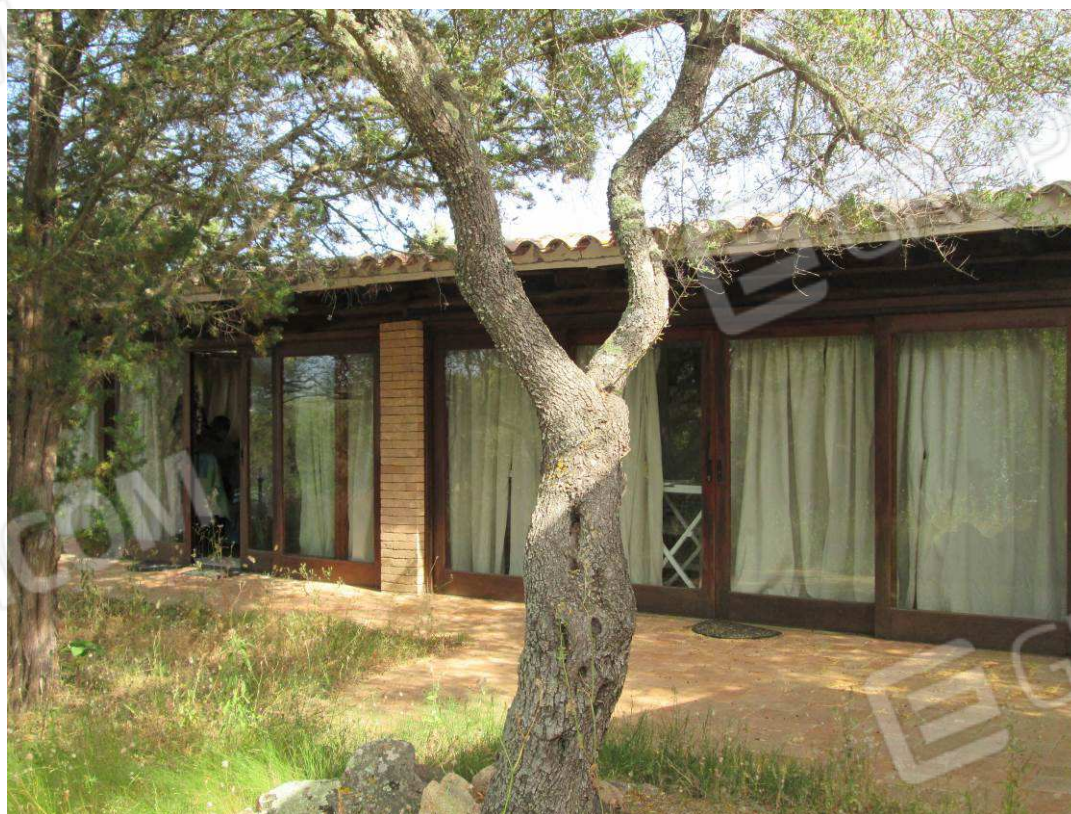
Foto n° 2 – Veranda chiusa lato Nord – parte non condonabile
