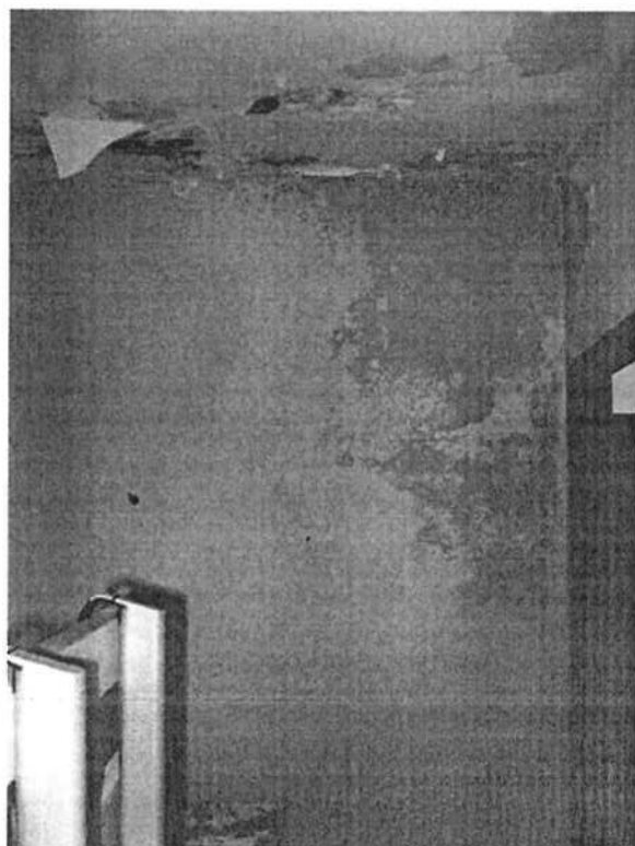
Foto n° 20 – Infiltrazioni d'acqua nella camera al piano primo.
