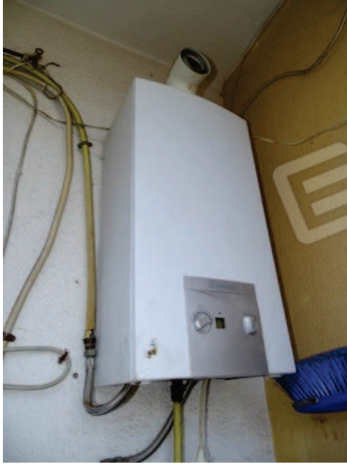
Balcone con accesso dalla cucina. Caldaia a gas per impianto idrico-sanitario
