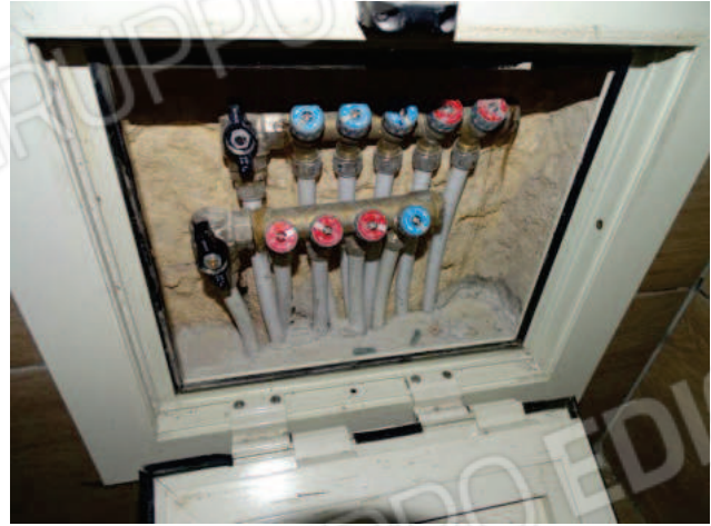
Locale wc bagno. Particolare dell'impianto idrico a collettore
