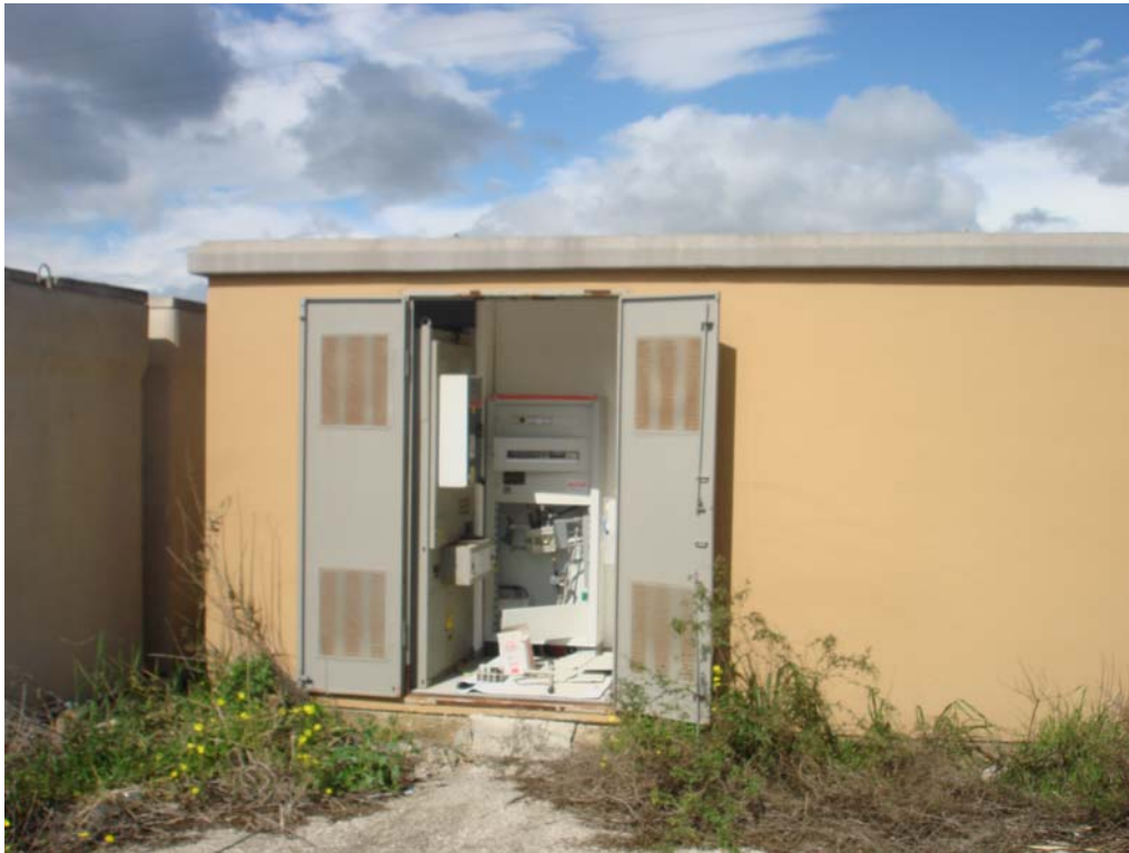
Fotografia n. 37 – Cabina elettrica per alloggiamento trasformatore.
