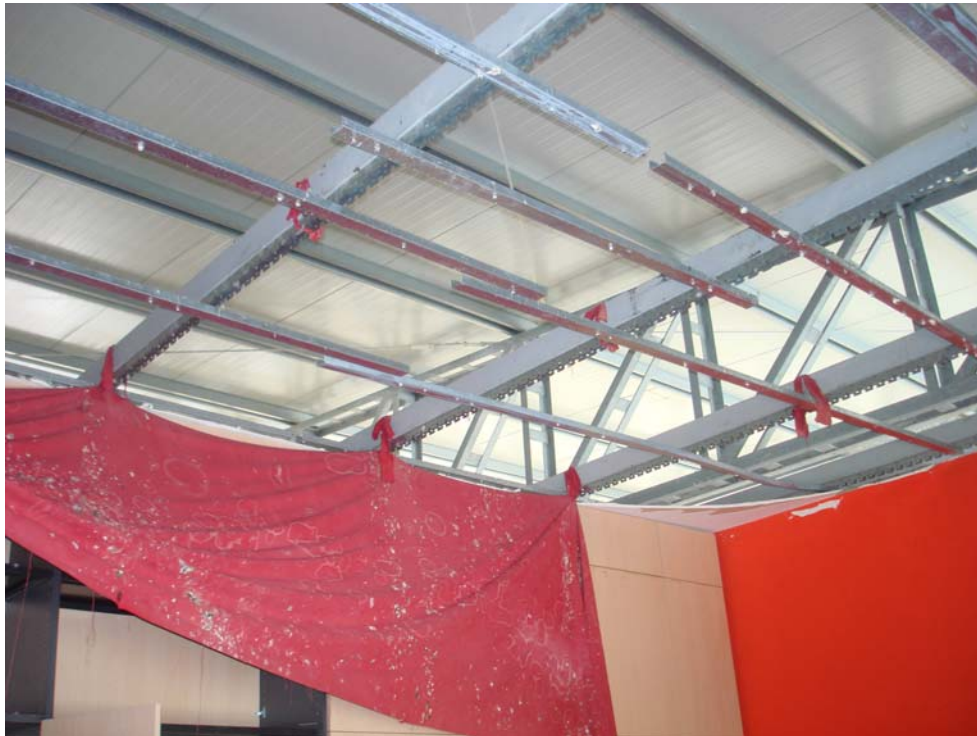
Fotografia n. 30 – Particolare travi reticolari a sostegno della copertura del capannone nell'area della palazzina Uffici.
