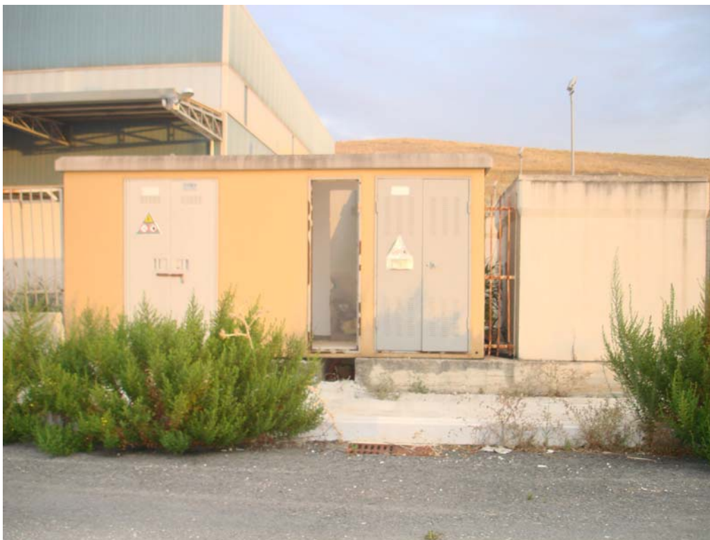
Fotografia n. 38 – Cabina elettrica e riserve idriche.
