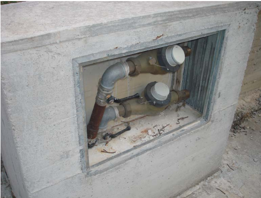
Fotografia n. 40 – Punto allaccio impianto idrico.
