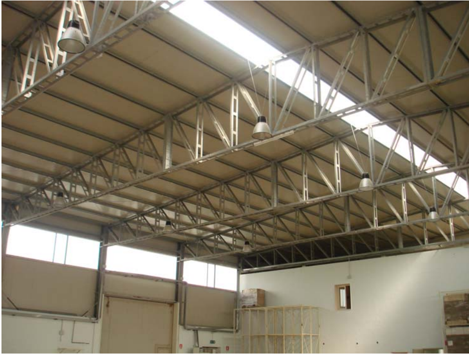
Fotografia n. 29 – Particolare travi reticolari a sostegno della copertura del capannone nell'area destinata alla produzione.
