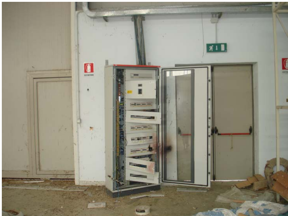
Fotografia n. 28 – Particolare quadro elettrico all'interno del capannone.
