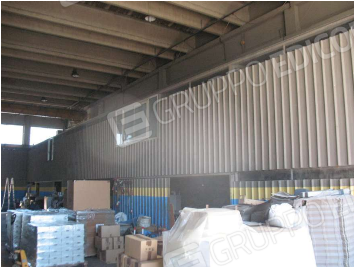
Foto 9 - Interno Capannone (A): In evidenza superfetazione A2
