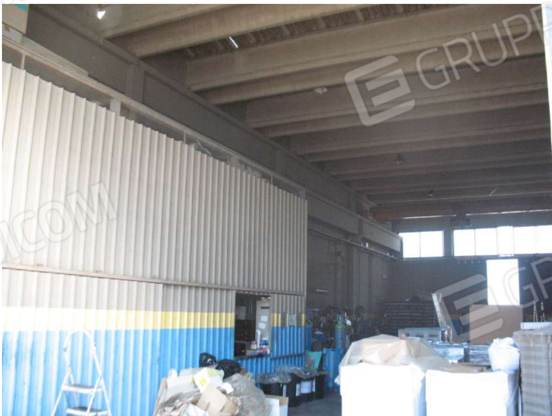
Foto 8 - Interno Capannone (A): In evidenza superfetazione A1
