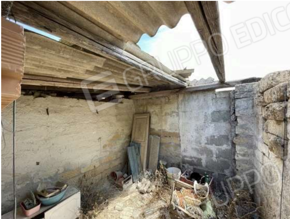
Fotografia D.59 - Interno e copertura precaria
