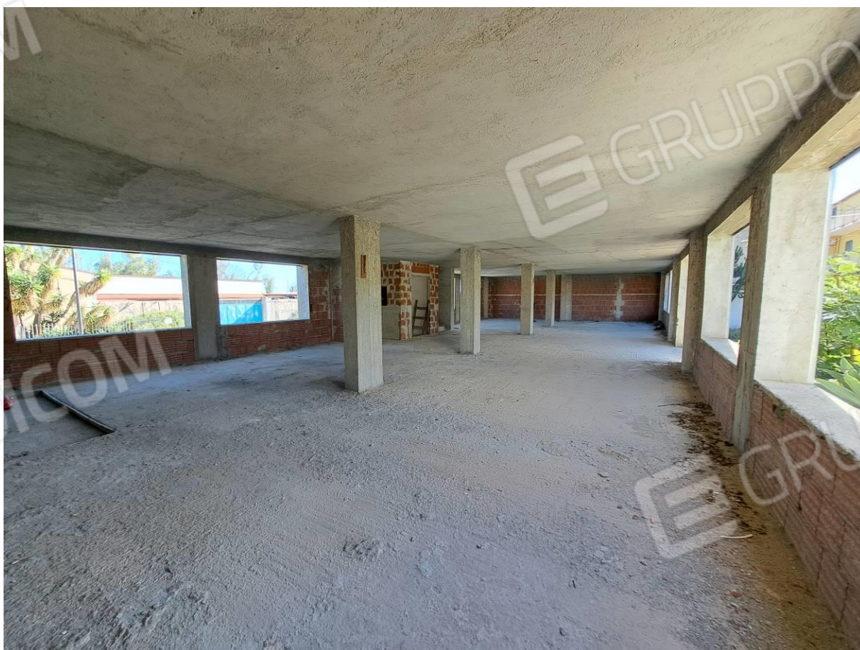
foto 40 – Edificio in corso di costruzione in Priolo Gargallo, via Boscarino (piano rialzato)
