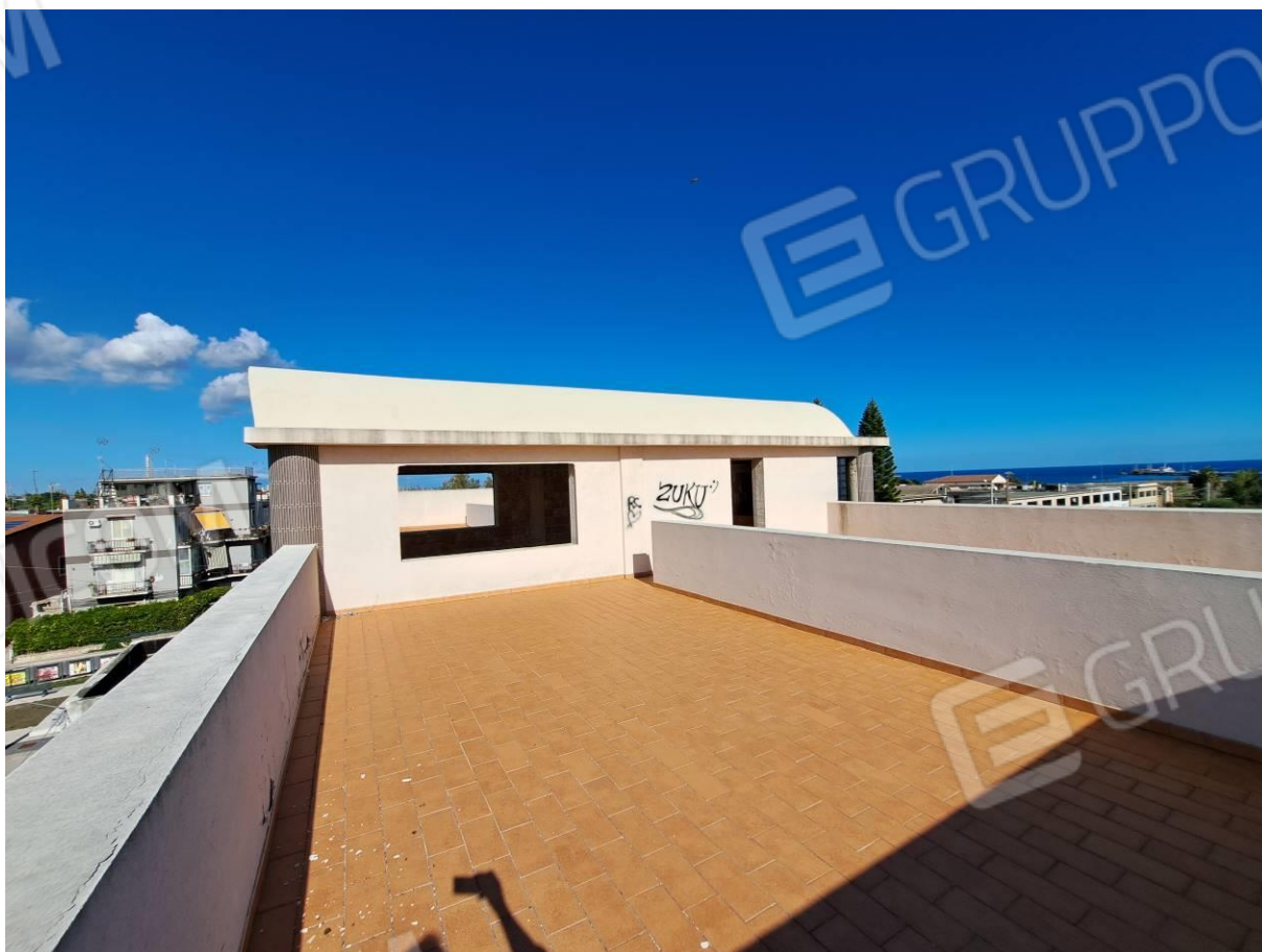
foto 46 – Edificio in corso di costruzione in Priolo Gargallo, via Boscarino (piano terzo)
