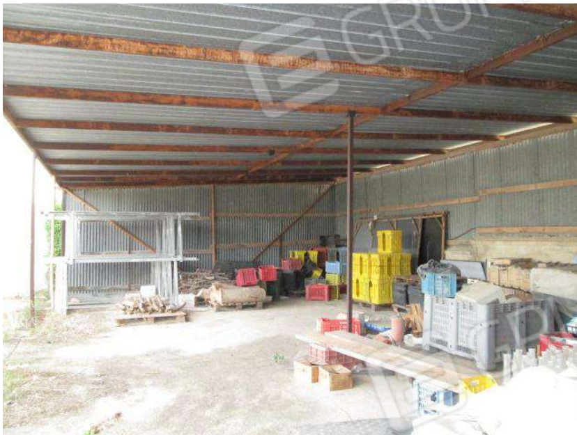
Foto 71. Vista del Corpo F.1 - Deposito.
