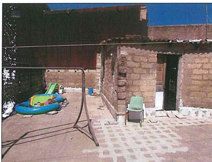
foto 21 - L'ambiente dante sulla terrazza non è rifinito in facciata, è coperto con struttura in legno ed eternit e non si trova in buono stato conservativo.
