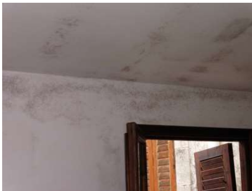
Foto 11 – Appartamento 6A – Presenza di condensa nella camera
