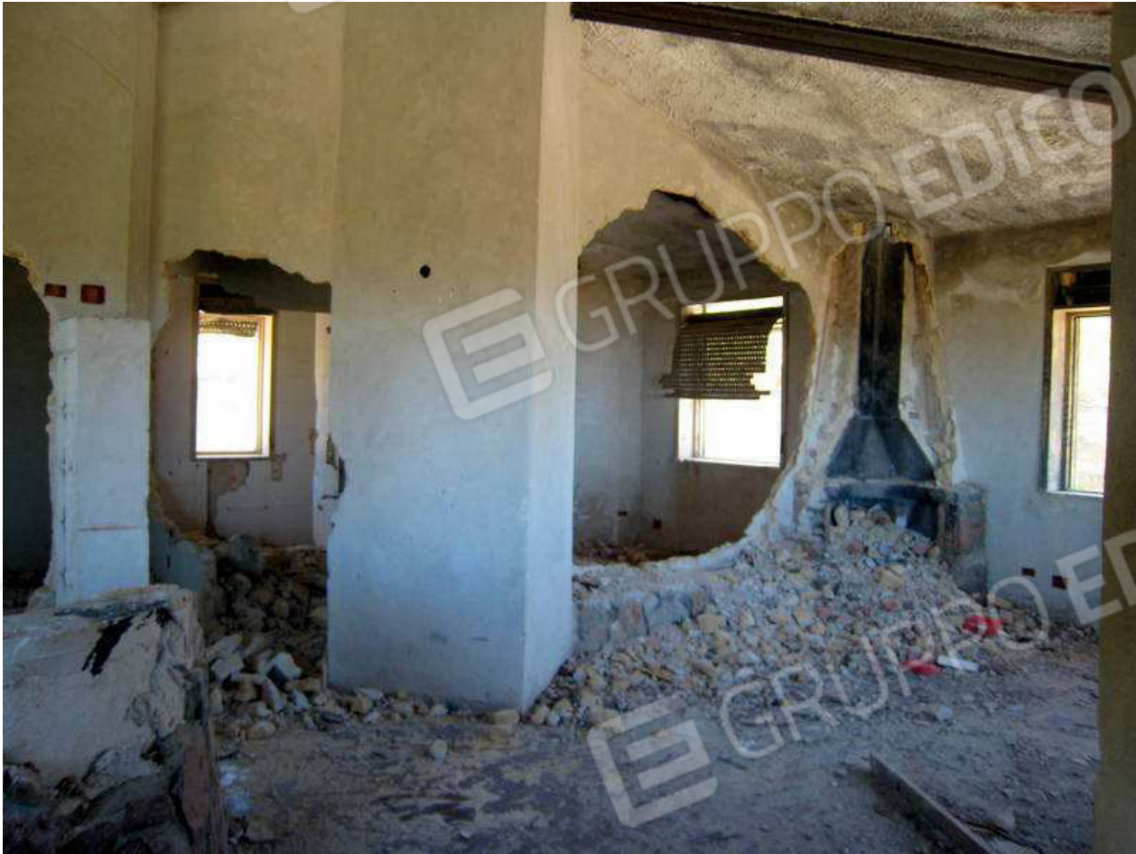
Foto n. 25. Il soggiorno è anch'esso distrutto.
