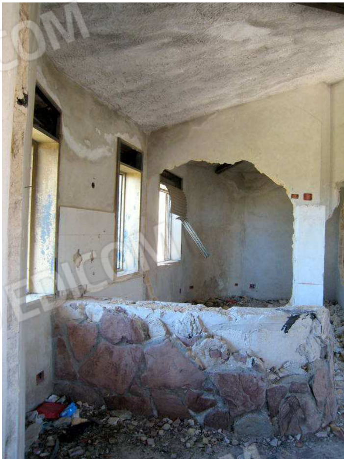
Foto n. 20. Gli interni. La zona cucinino è distrutta.
