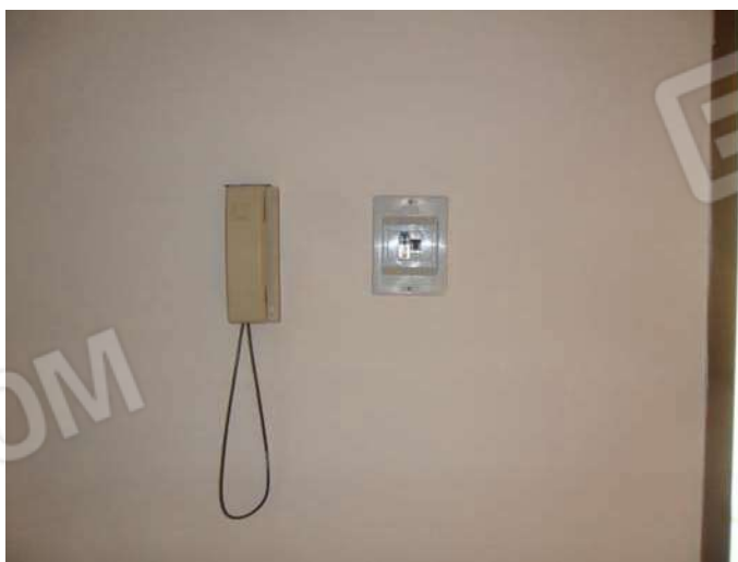
Foto n. 10: Citofono e interruttore
