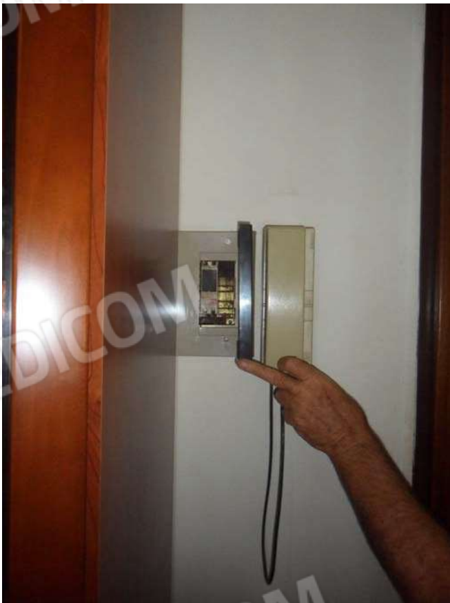
Foto n. 02: Citofono e interruttore
