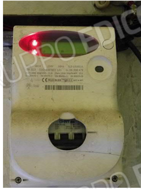
78 Contatore energia elettrica, posto al piano terra
