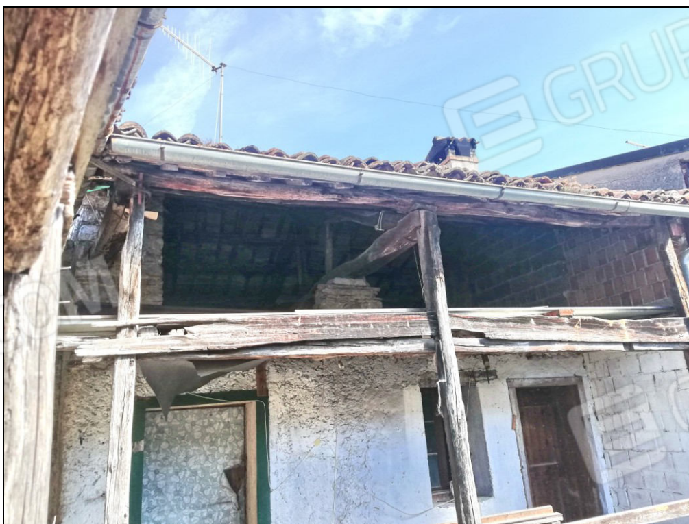
Foto 14 – Soffitta con terrazza non accessibili piano secondo
