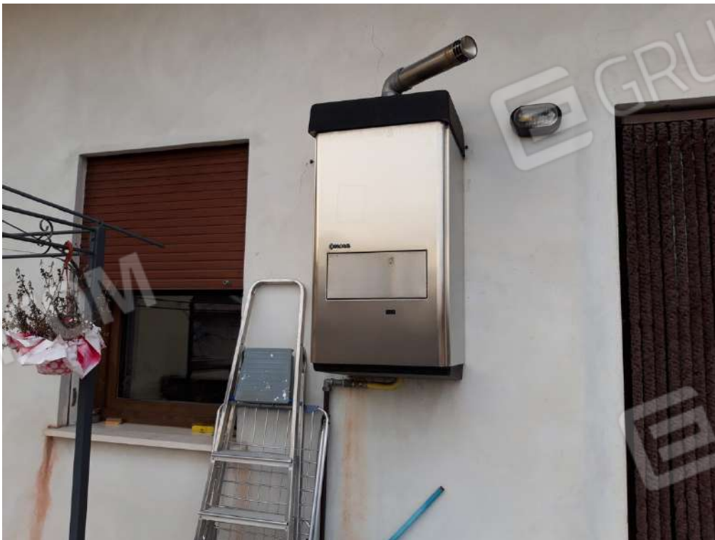
Particolare caldaia su terrazza ovest
