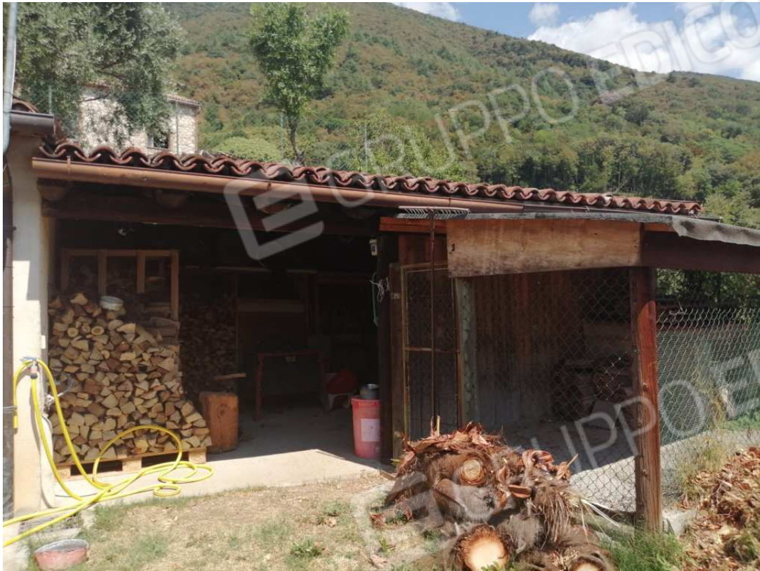
Tettoia in legno abusiva
