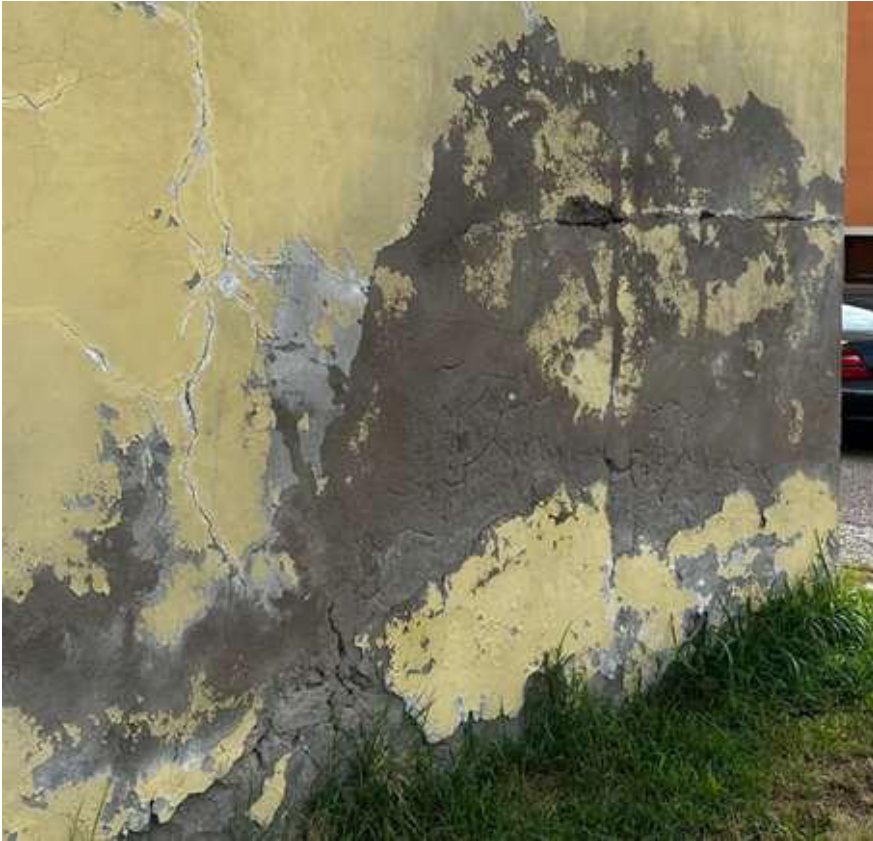
Figura 4: esterni - dettaglio ammaloramenti su parete ovest
