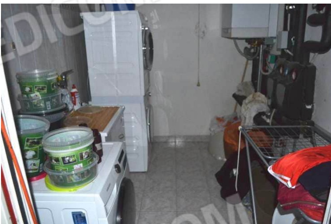
foto 27 - Scorcio della centrale termica e lavanderia
