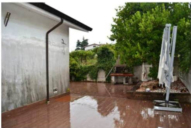
foto 4 - scorcio del prospetto nord est (sinistra foto) sul retro del villino in via Libertà visto da est, con la parete esterna del piano terra – zona soggiorno con tetto in falda – con vistosa igrofanìa e affioramento di muffe a seguito d'inadeguato presidio del dilavamento e dell'isolamento termico
