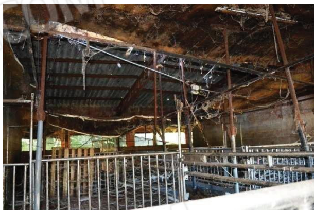
foto 27c – Copertura puntellata e pericolante di un modulo della stalla da ristrutturare
