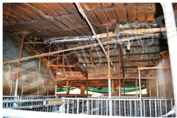
foto 26b - Copertura collassata e puntellata di un modulo della stalla da ristrutturare
