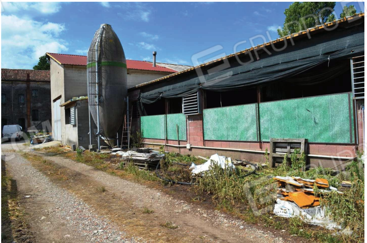
foto 16 – Stalla e annessi rustici m.n. 355 CEU, fianco est (parte sud vista da nord est) – scorcio della parte sud del prospetto est della stalla con il collegamento all'impianto d'alimentazione (tra il silos e il deposito a sud est dei rustici). In primo piano si vede lo stradello di servizio della stalla (il m.n. 102 CT)
