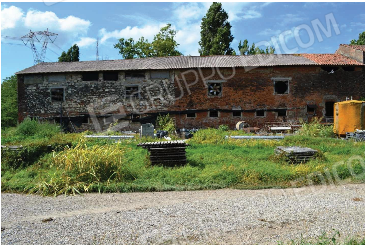
foto 4 – Stalla m.n. 107-117 CT, prospetto nord (visto da nord) - il prospetto nord della stalla m.n. 107-117 CT è la parte con falda in eternit, dove si vedono in sequenza dal basso le finestre della stalla, i quattro fori per la ventilazione forzata e le sei luci dell'ex fienile con parete in vivo e cotto. La copertura della falda nord è costituita da eternit su scortecciato e telaio di travetti, travi secondarie e capriate in legno
