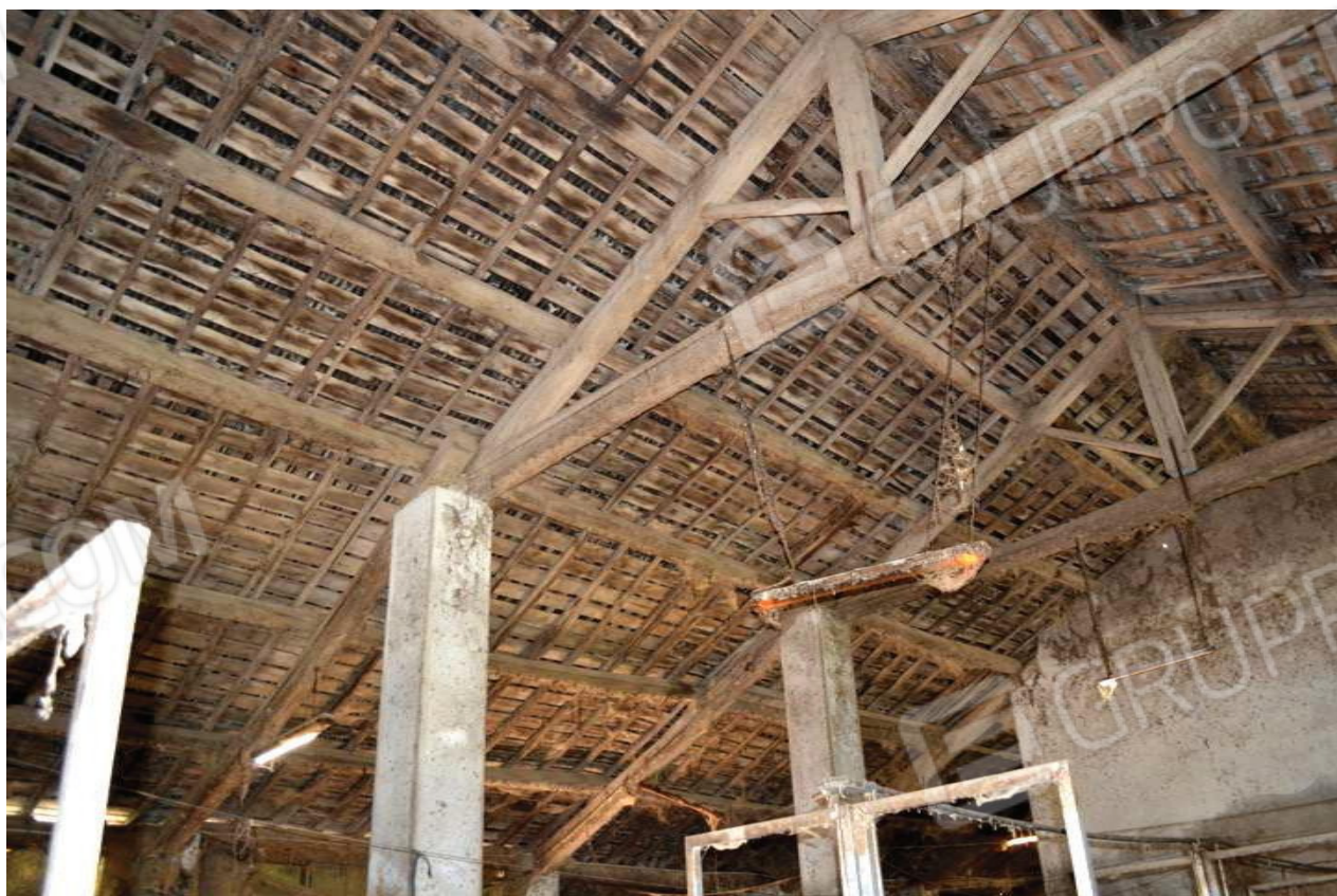
foto 12 – Stalla m.n. 107-117 CT, copertura dell'ex fienile - vista dell'interno della falda di copertura dell'ex fienile e dell'ex portico sud: le condizioni strutturali appaiono mediocri, con evidenze di igrofanie per infiltrazioni d'acqua con bagnamento delle parti strutturali e deformazioni che richiedono adeguate verifiche strutturali e manutenzioni di presidio e ristrutturazione delle parti funzionalmente compromesse
