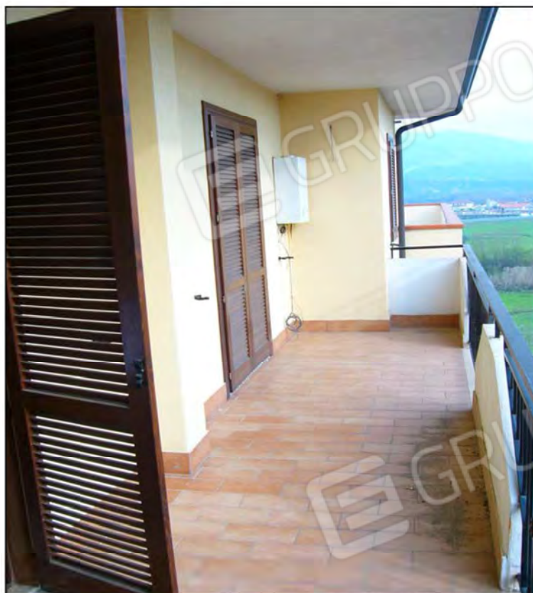
(Foto 102 – balcone appartamento al 3° piano di Via B. Croce – Part. n°1033, Sub. 6)
