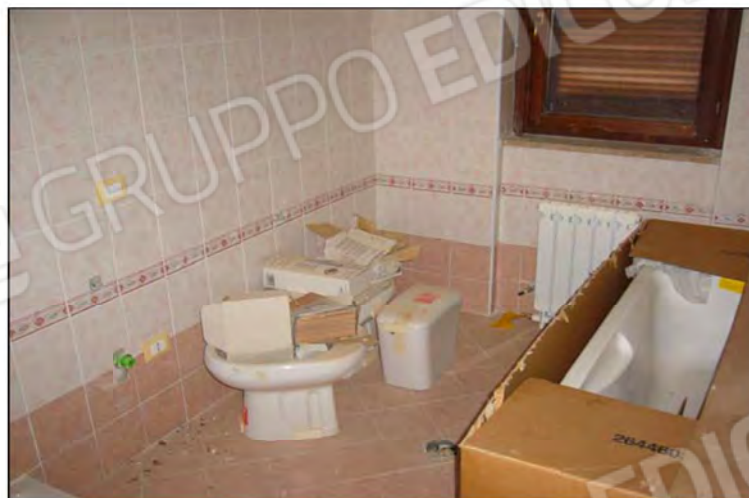
(Foto 75 – appartamento 2° piano di Via B. Croce – Part. n°1033, Sub. 5)
