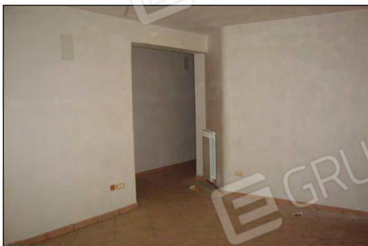
(Foto 74 – appartamento 2° piano di Via B. Croce – Part. n°1033, Sub. 5)
