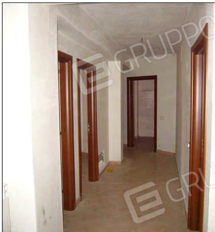
(Foto 80 – appartamento 2° piano di Via B. Croce – Part. n°1033, Sub. 5)
