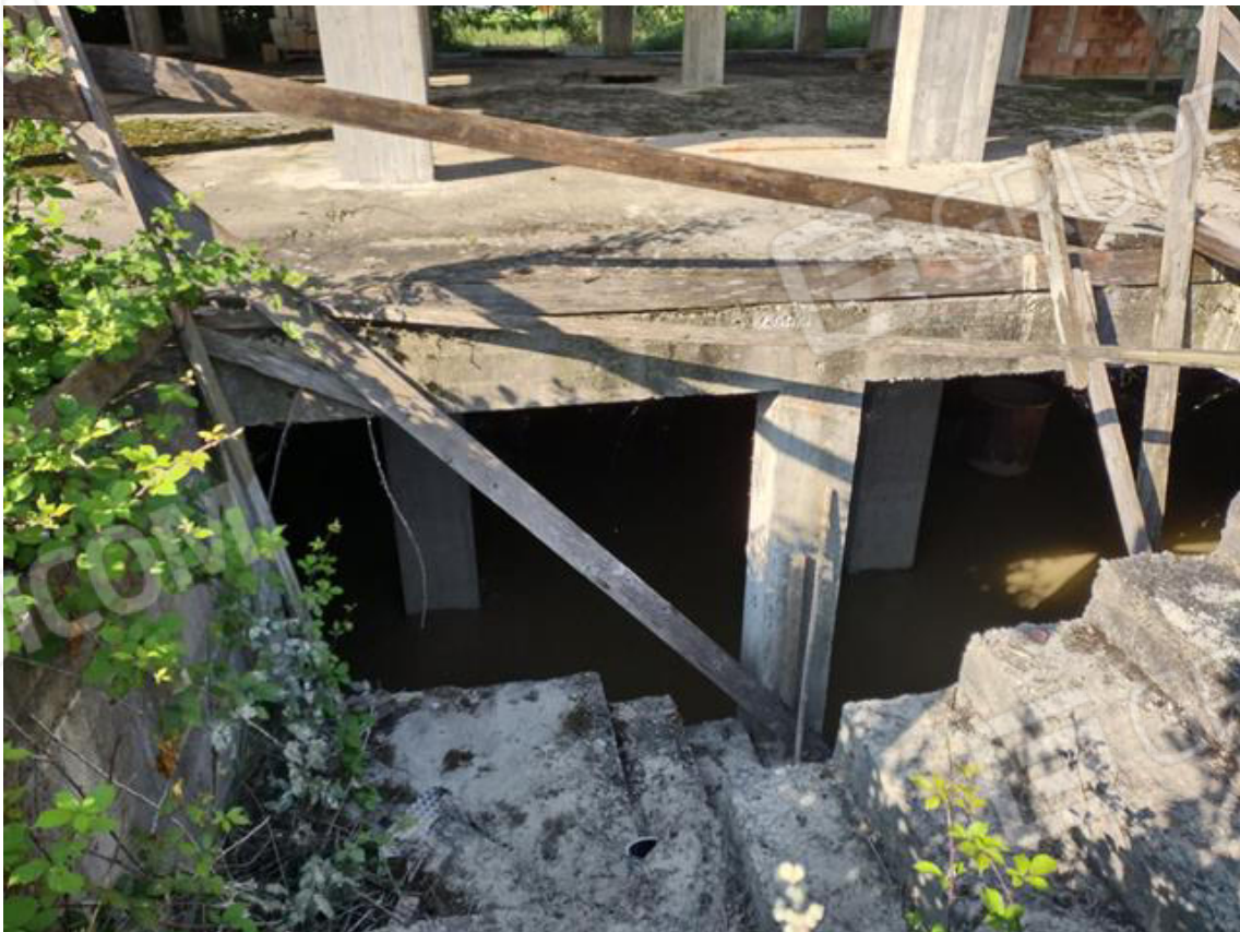
FOTO 8. Fabbricato in costruzione: scala di accesso dalla corte al piano interrato invaso del fango
