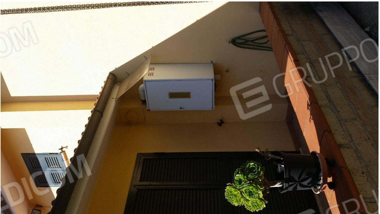
FOTO 18 TERRAZZO LATO SUD-EST CON POSIZIONE CALDAIA MURALE ESTERNA
