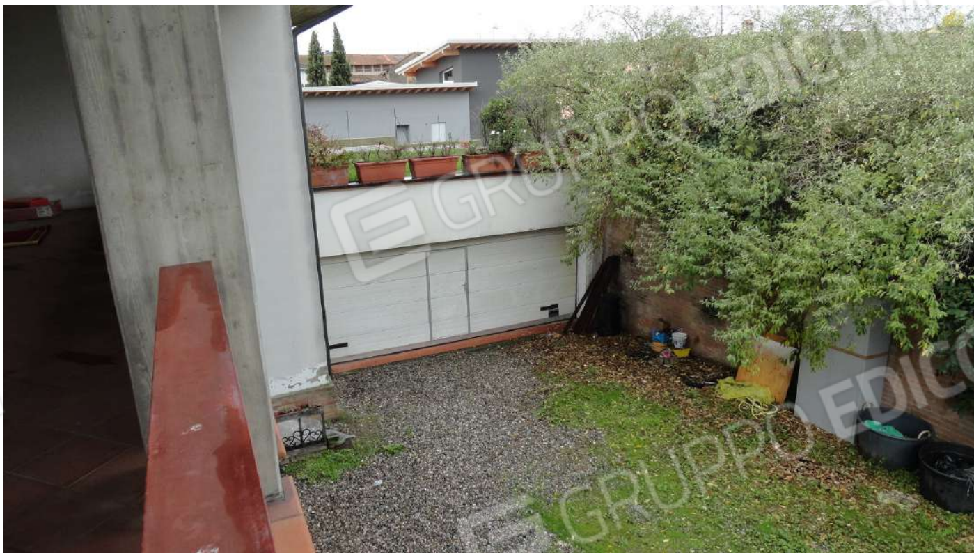
Fotografia n. 18 bis : autorimessa e sulla destra muro di contenimento terra riportata per creare giardino
