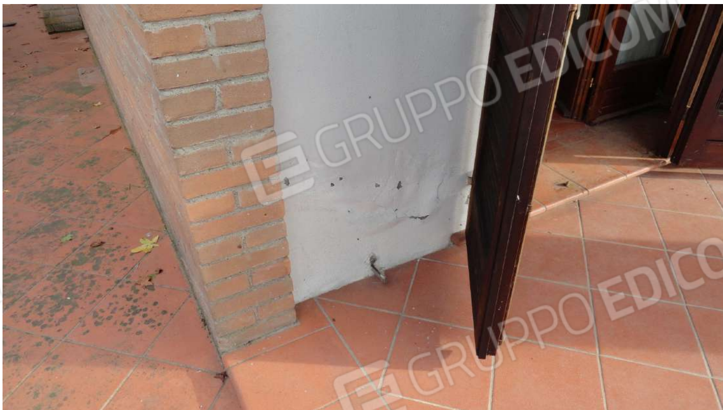
Fotografia n. 112: umidità camera singola esterna
