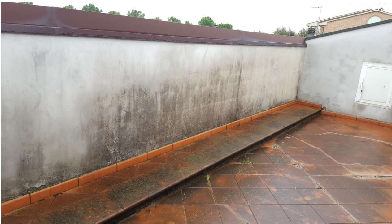
PARTICOLARE DEGRADO PAVIMENTAZIONE
