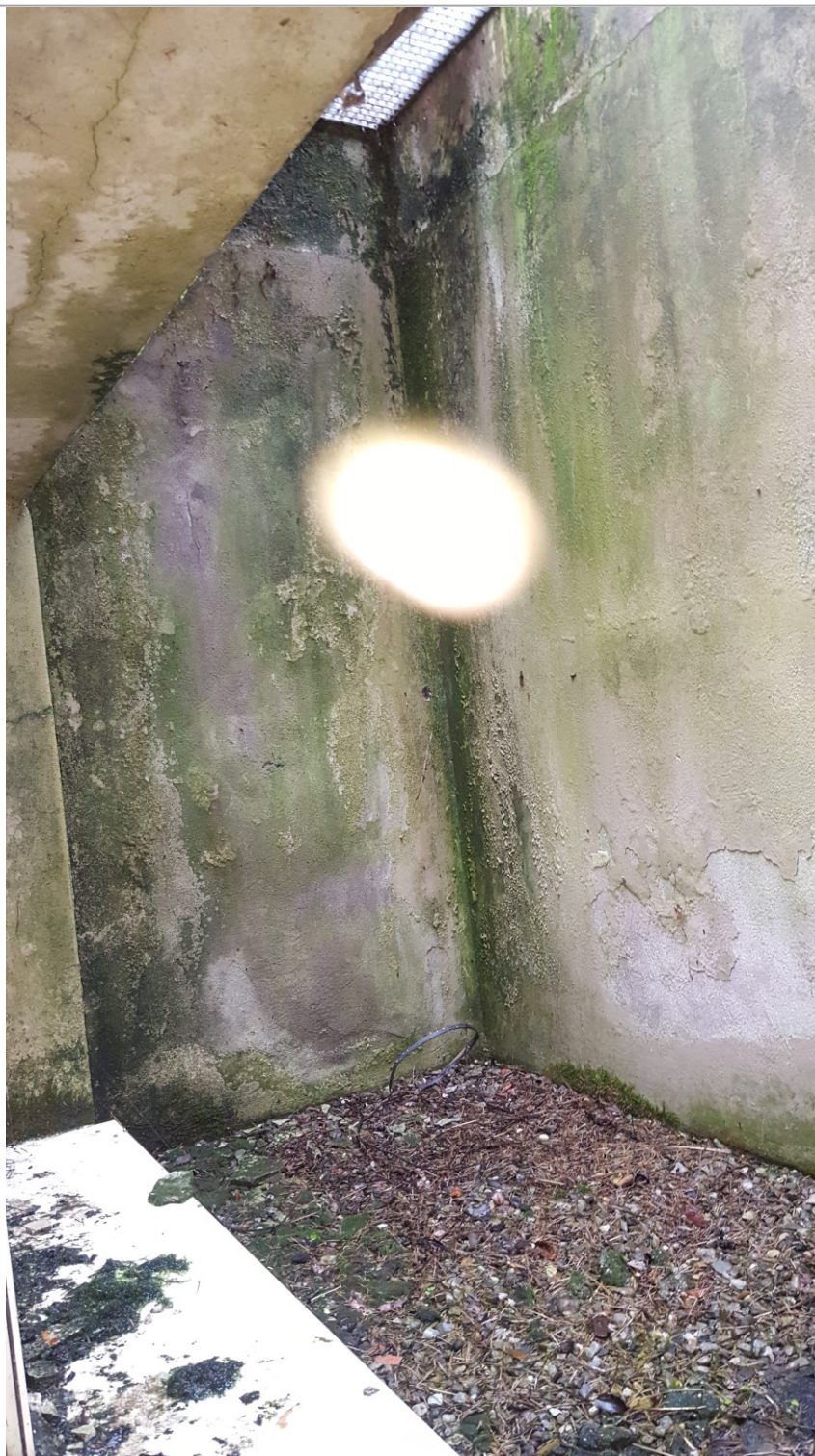
altra rappresentazione del forte deterioramento delle murature
