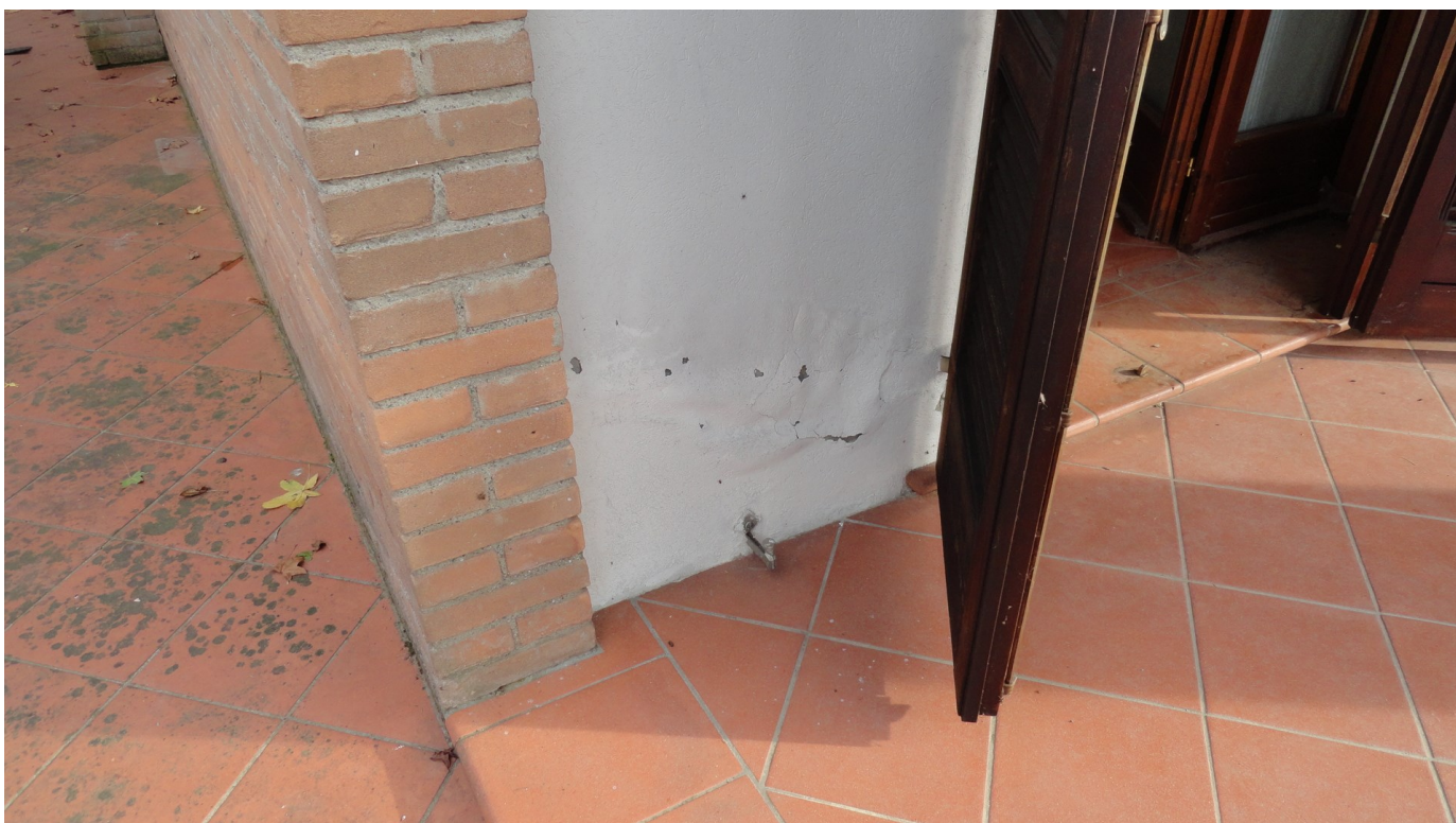
d) altro scrostamento di intonaco esternamente in lato Nord-Nord-Ovest
