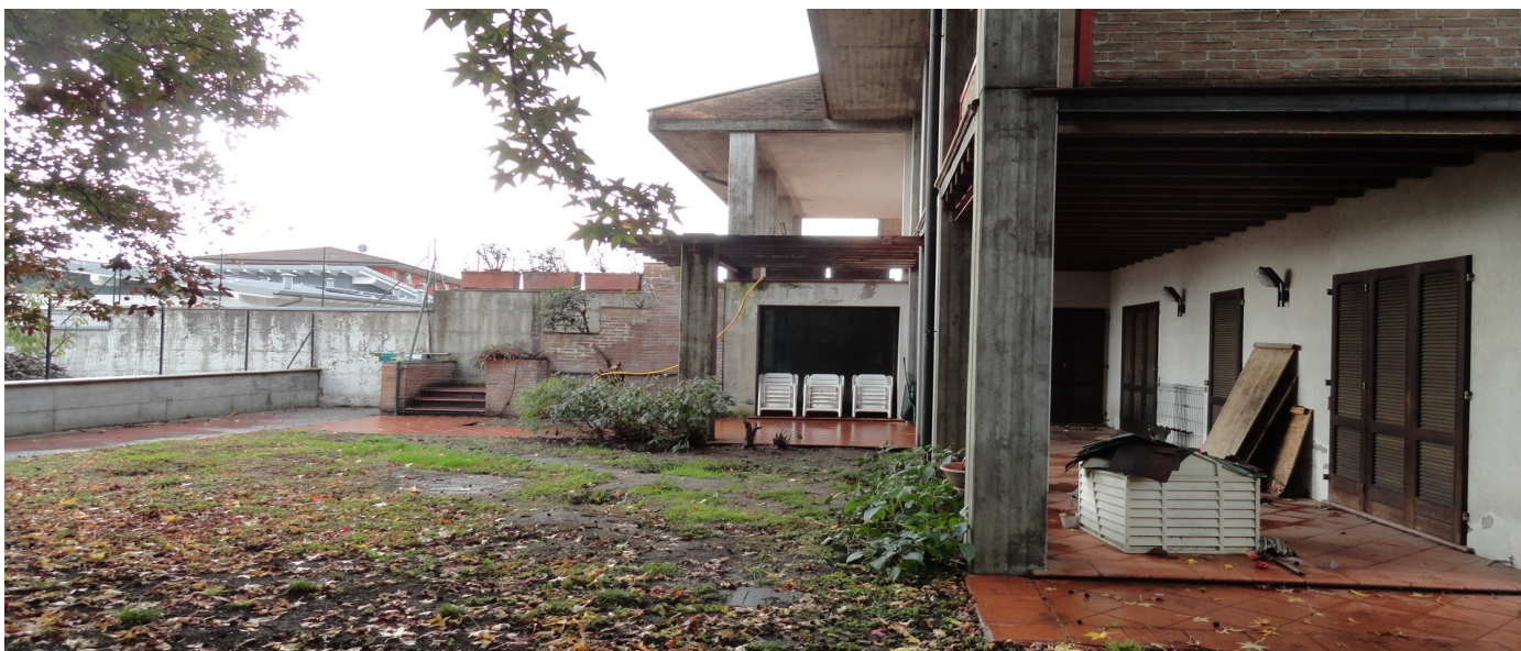
c) Sulla destra in basso della prima persiana e fra la prima e la seconda persiana sono visibili scrostamenti dell'intonaco
