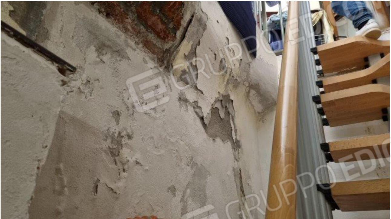
scala interna accesso cantina (senza titolo)
