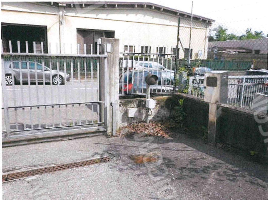
Foto 12 - Alcuni impianti agli ingressi su strada
