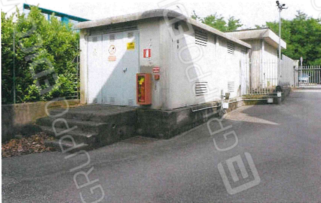
Foto 17 – La cabina elettrica
