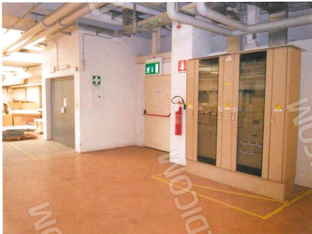
Foto 12 – Il montacarichi centrale
