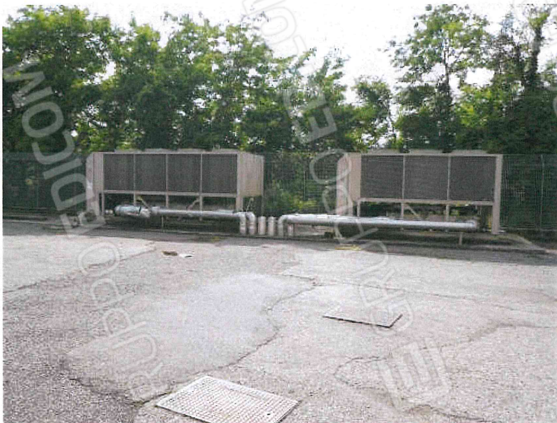
Foto 15 – Le unità esterne di condizionamento sul retro
