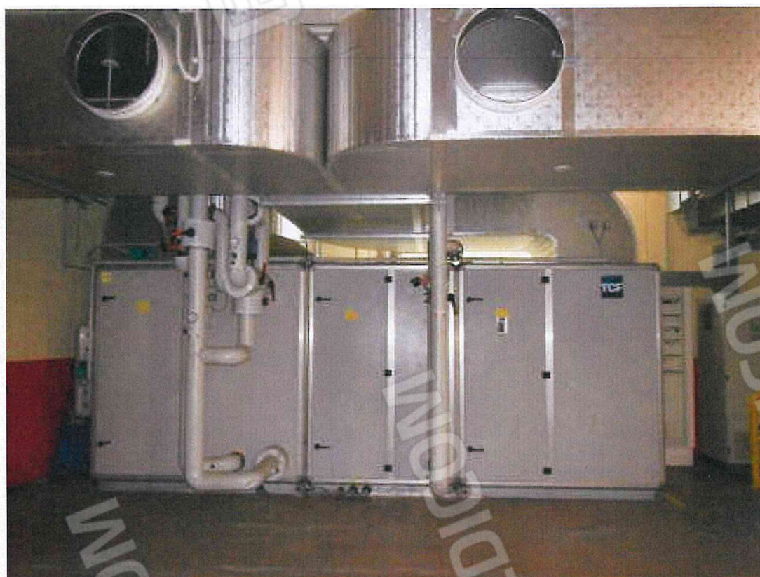
Foto 18 – Alcuni impianti più recenti
