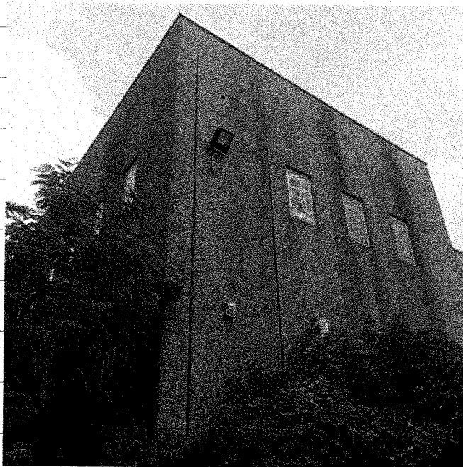
ANGOLO NORDOVEST/SUDOVEST DEL CAPANNONE CON MANIFESTO INGOMBIMENTO DEI PANNELLI TAMPONANTI
