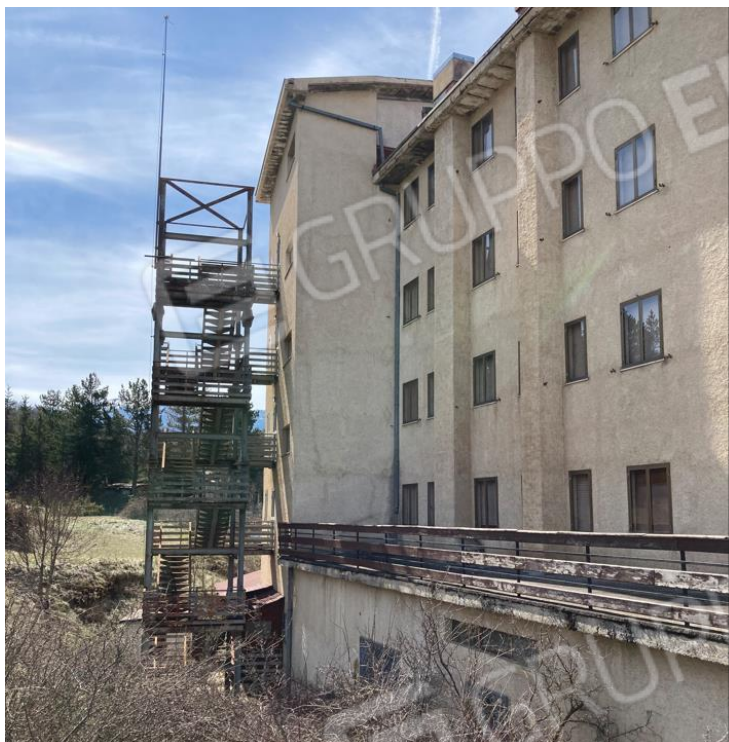
SCALA ESTERNA IN FERRO FUORI ESERCIZIO LATO NORD EST
