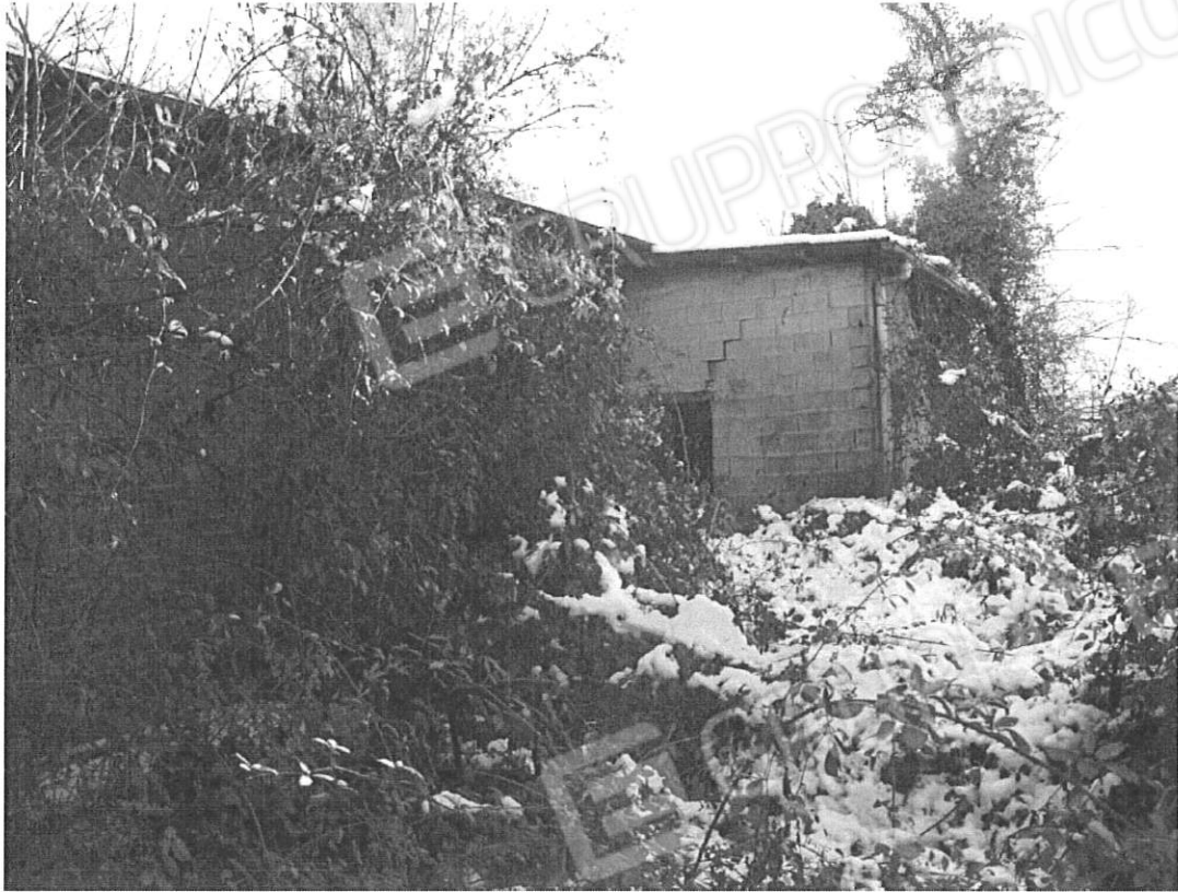
Figura 11 vano esterno al vecchio capannone, licenziato ma probabilmente difforme, pericolante e completamente inaccessibile alla verifica (lato nord)
