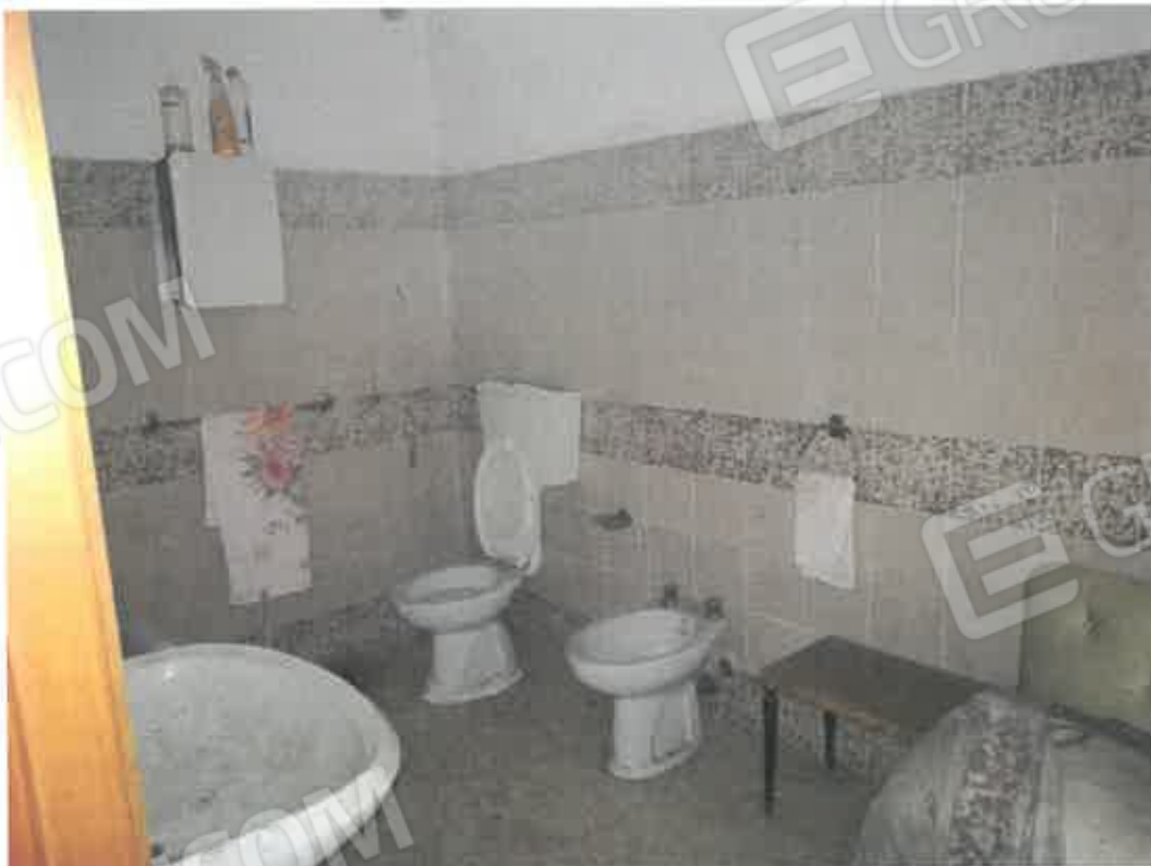
Foto n. 12_ Bagno al piano primo
