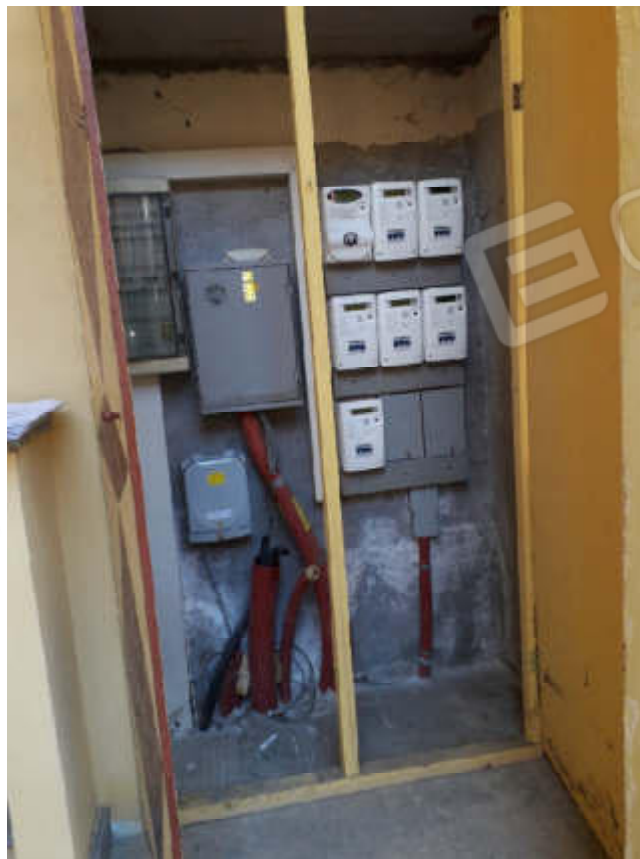
Vista particolare del quadro elettrico condominiale
