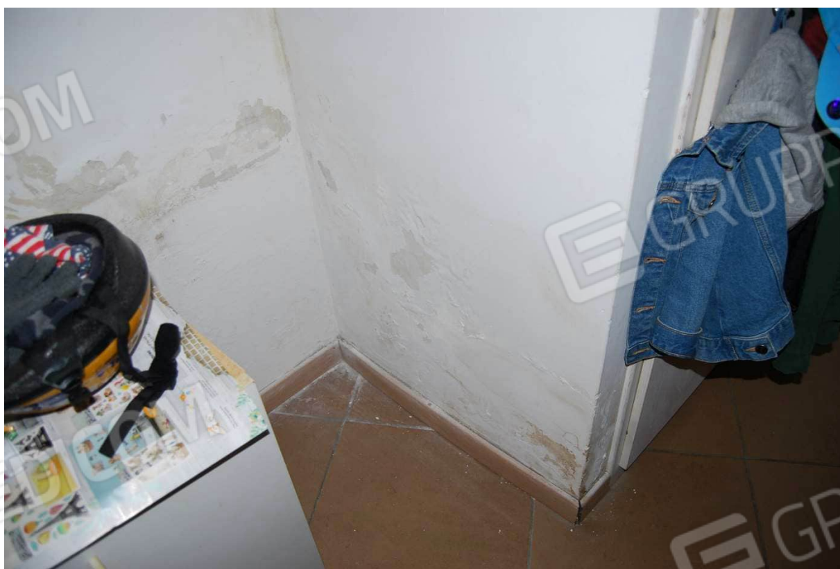
LOTTO 1 - Pareti ingresso interessate parzialmente da umidità, efflorescenze, alloggio sub.1, piano 1°, foto 23-24)
