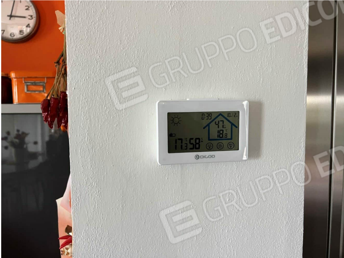
Figura 11 particolare pannello di controllo
