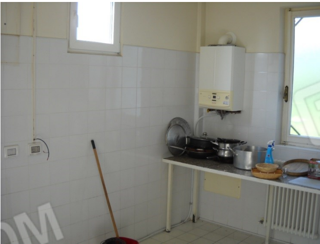
Locale commerciale retro con caldaia (sub.34)
