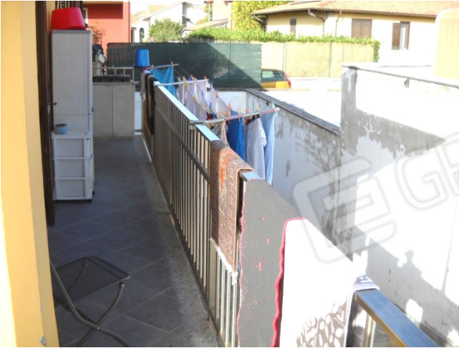
Balcone abusivo lato rampa
