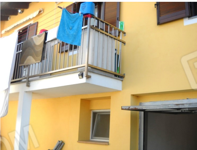
Balcone e finestra seminterrato abusivi
