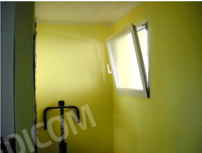
Finestra abusiva piano seminterrato (da interno)
