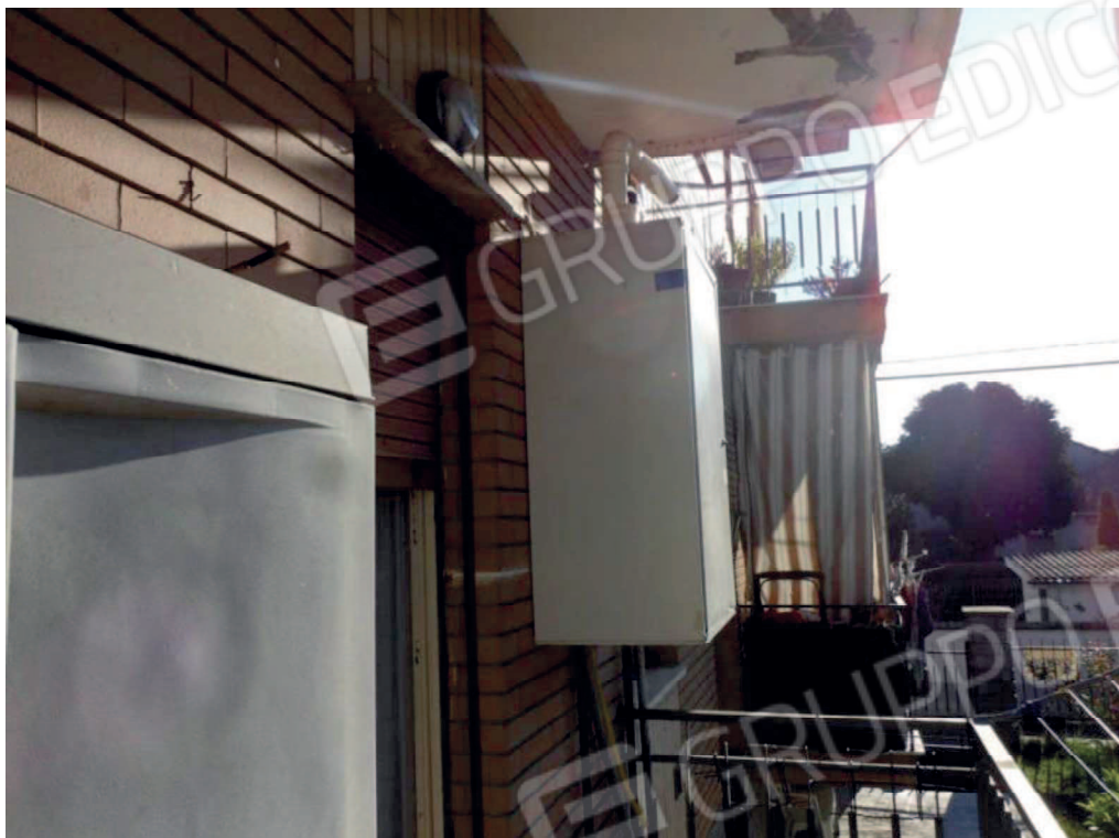
Foto 19 Caldaia su balcone alloggio mapp.851 sub.1 p.r.
