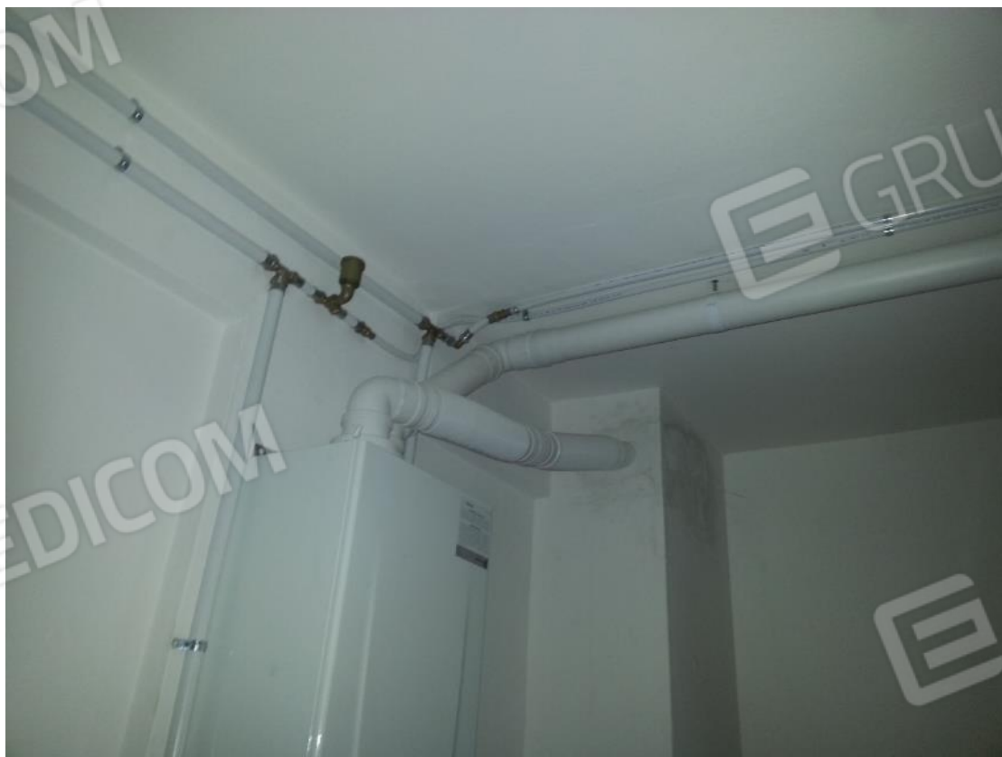
Foto 12 – Dettaglio impianti subalterno 12
