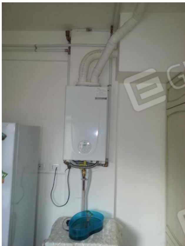
Foto 24 – Dettaglio caldaia e impianti subalterno 10
