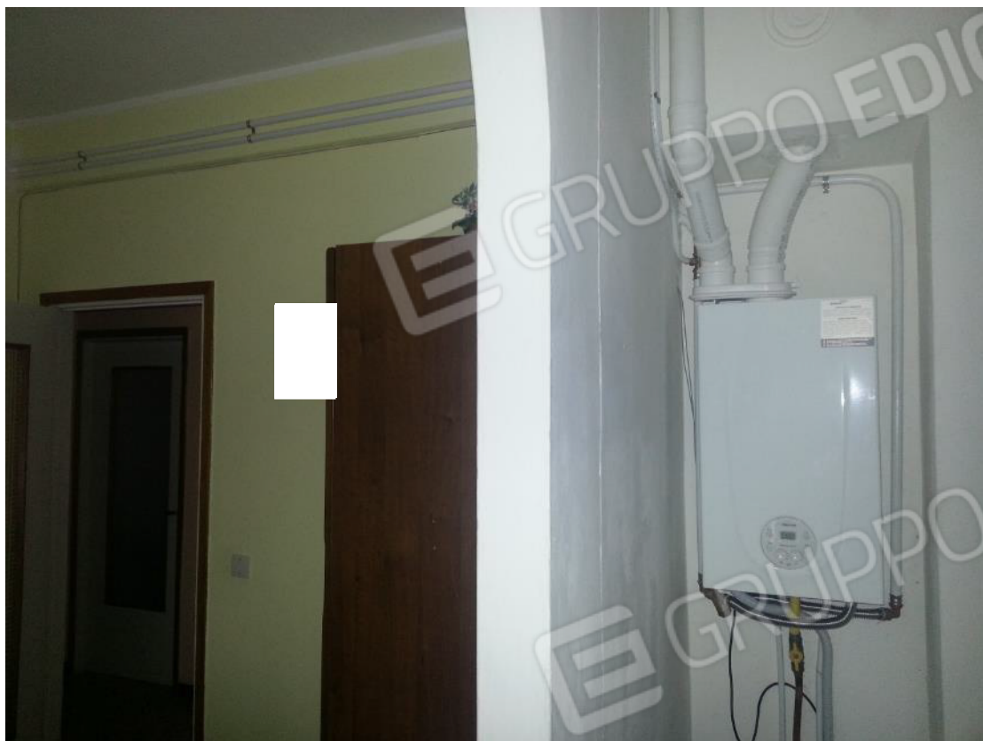
Foto 36 – Dettaglio caldaia e impianti subalterno 14
