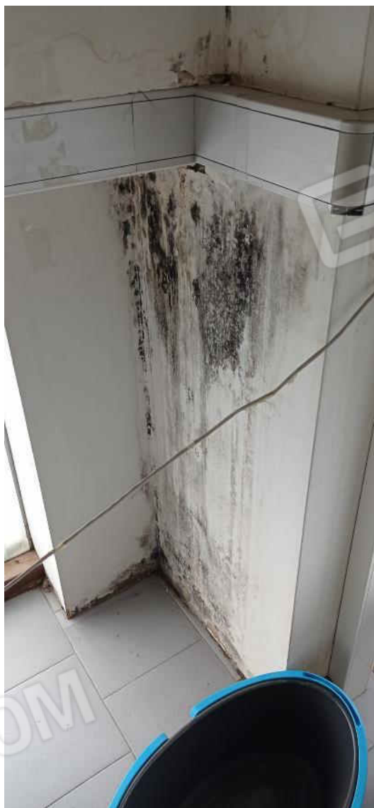
63-problematiche riscontrate a piano primo
